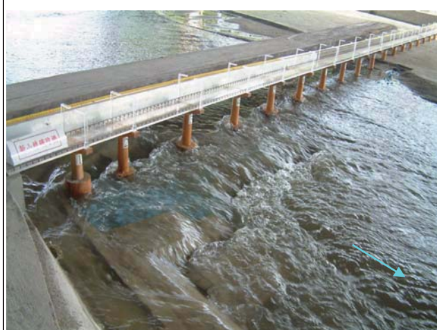
5. 試驗洪峰流量 4,525 秒立方公尺通過新山線鐵路橋流況
