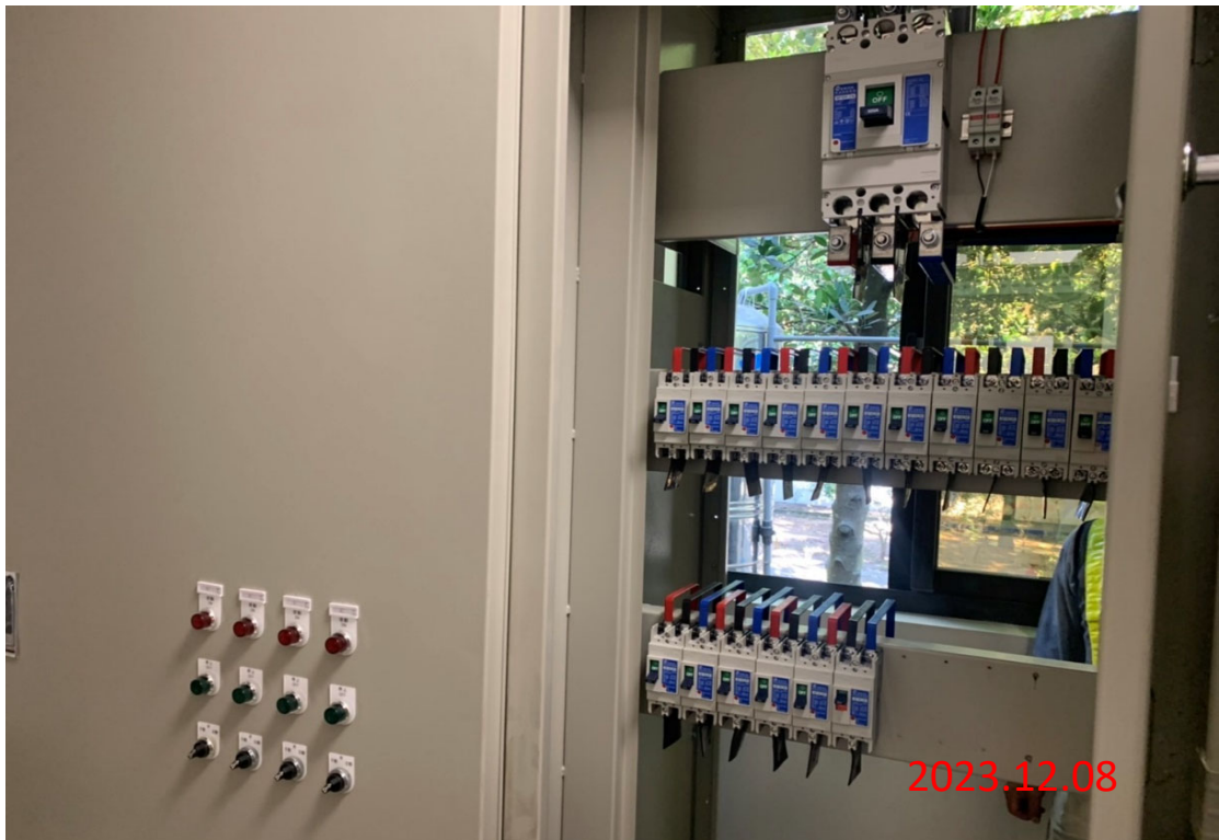
永續二館 總開關落地箱電信配線、弱電配線
