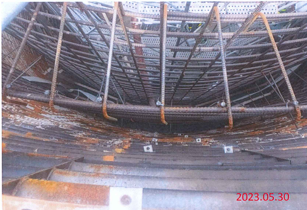
雙向備援工程 集水井井壁第一昇層(EL. 110~112.4) 350kgf/cm 2 混凝土澆置
