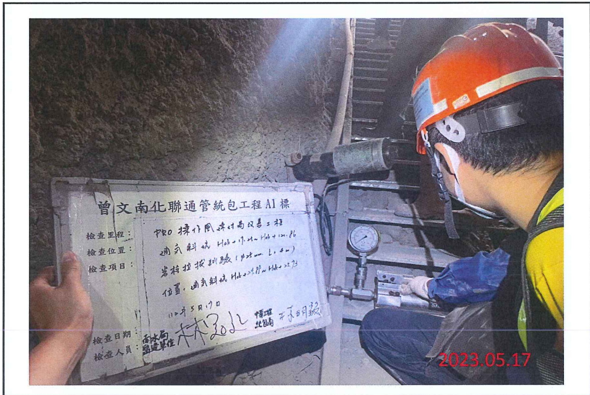
辦理PRO操作風速過高改善工程檢驗岩栓拉拔試驗，岩栓 \phi=25\text{mm} 、 L=4\text{m}
