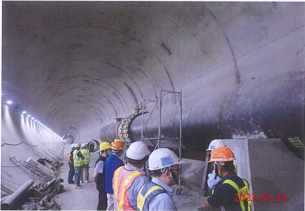
於112年5月24日下午2時辦理新建取水隧道充水致蝶閥基座及可撓管損壞 現勘
