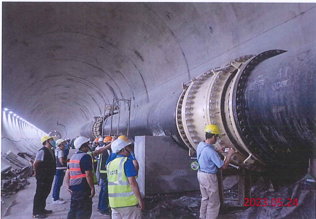
於112年5月24日下午2時辦理新建取水隧道充水致蝶閥基座及可撓管損壞 現勘
