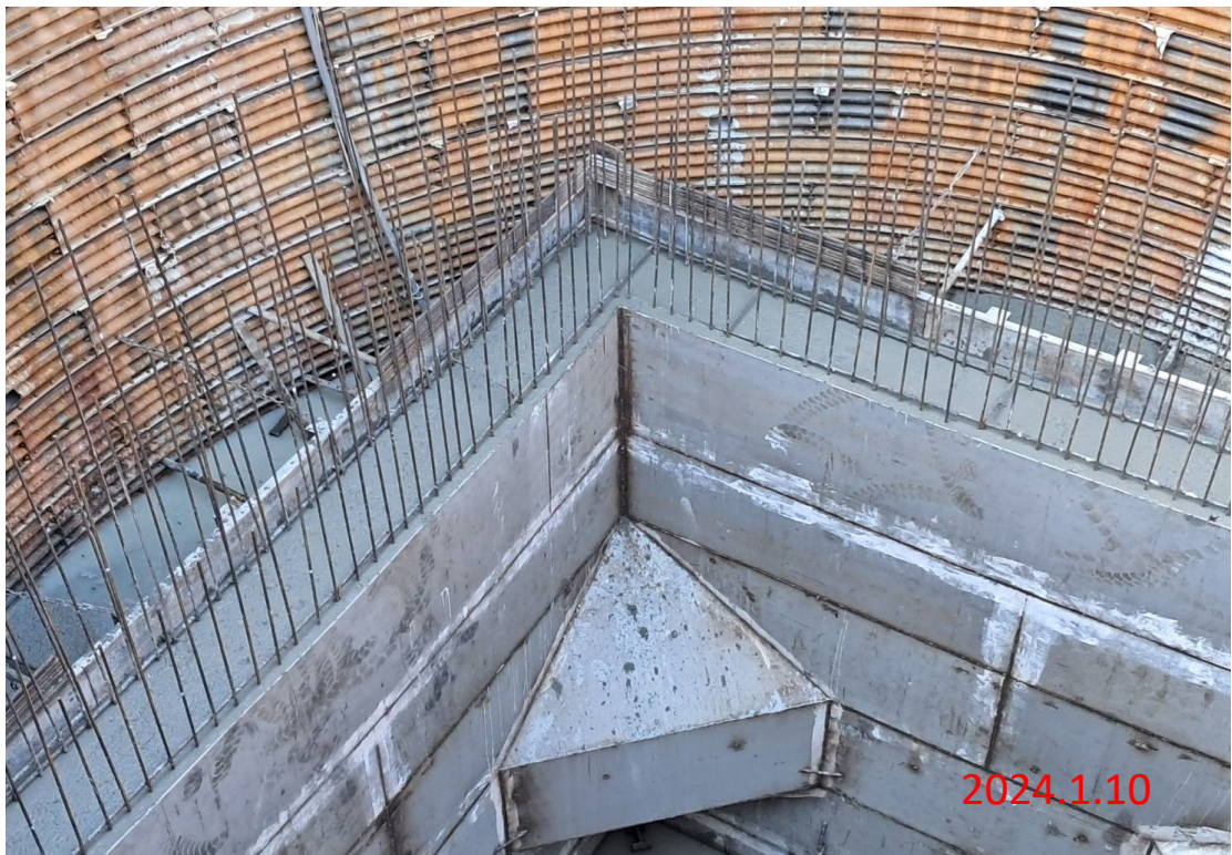
雙向備援工程 消能井牆身第六昇層(EL. 107.3~108) 350kgf/cm 2 混凝土澆置
