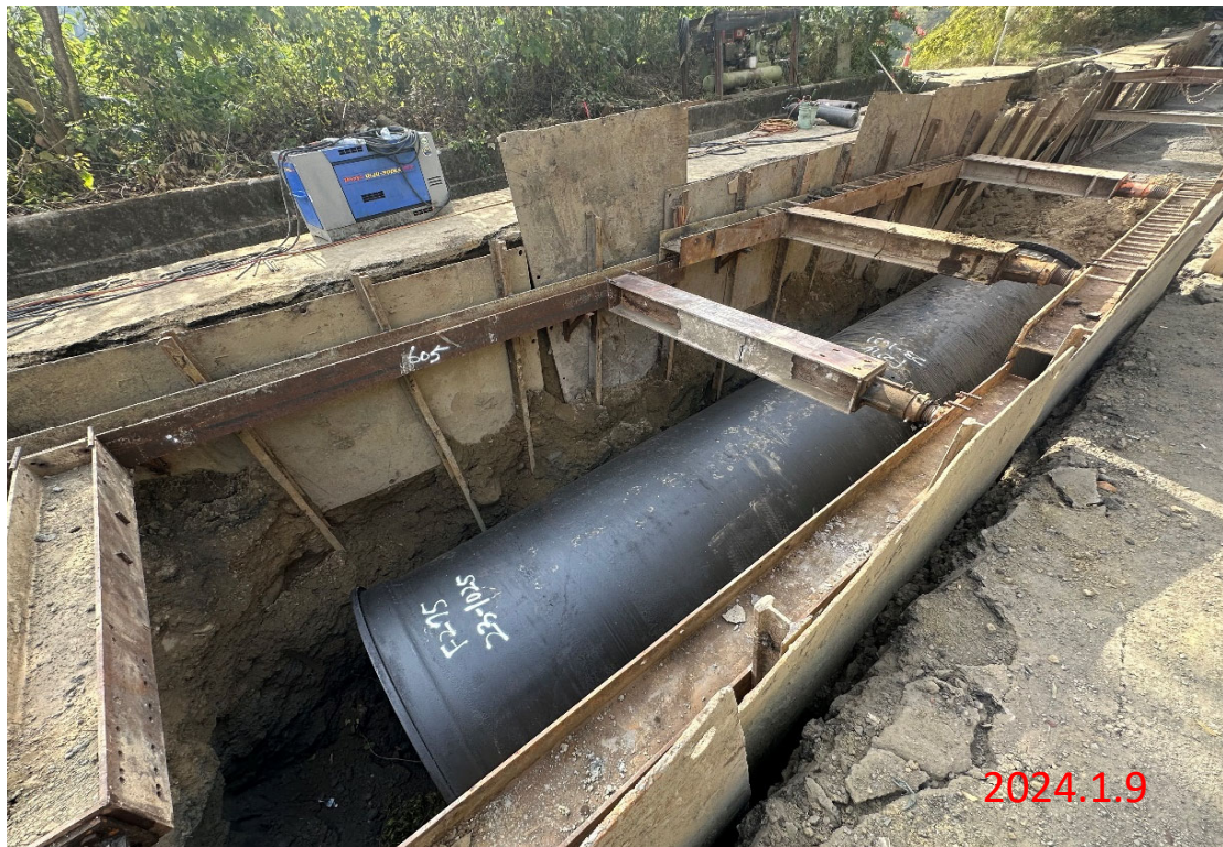
曾庫公路明挖段工程 6K+769.1~6K+775.1 土方開挖，K管理設， \phi 2600mm
