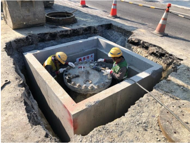
W50-1 檢修人孔窰井
