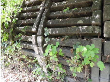
圖 1、#1 工區災害照片
