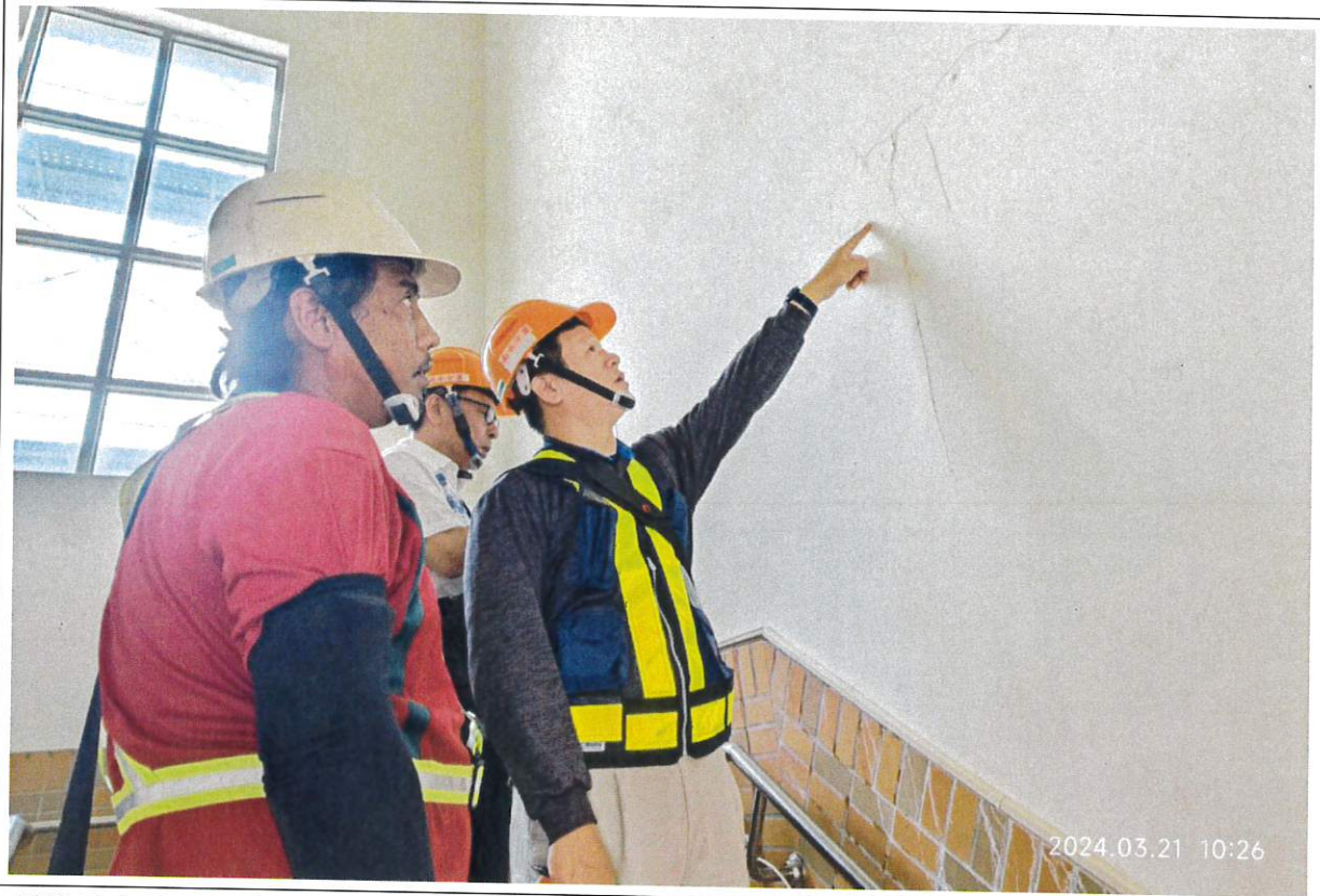
燕巢辦公園區 B 棟辦公室 3 樓樓梯間滲水情形
