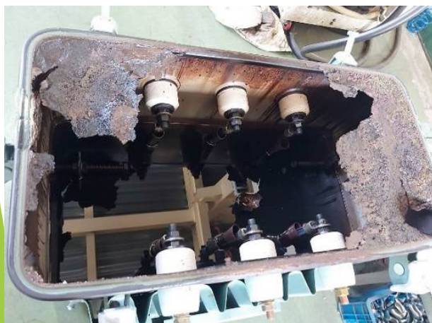
檢查絕緣油變質狀態
