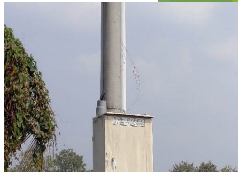
台電側電纜線受損
