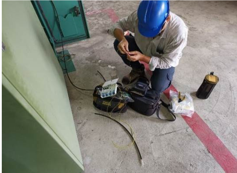
接入發電機室光纖箱
