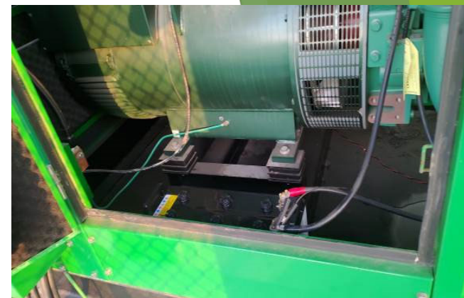
發電機電池故障
