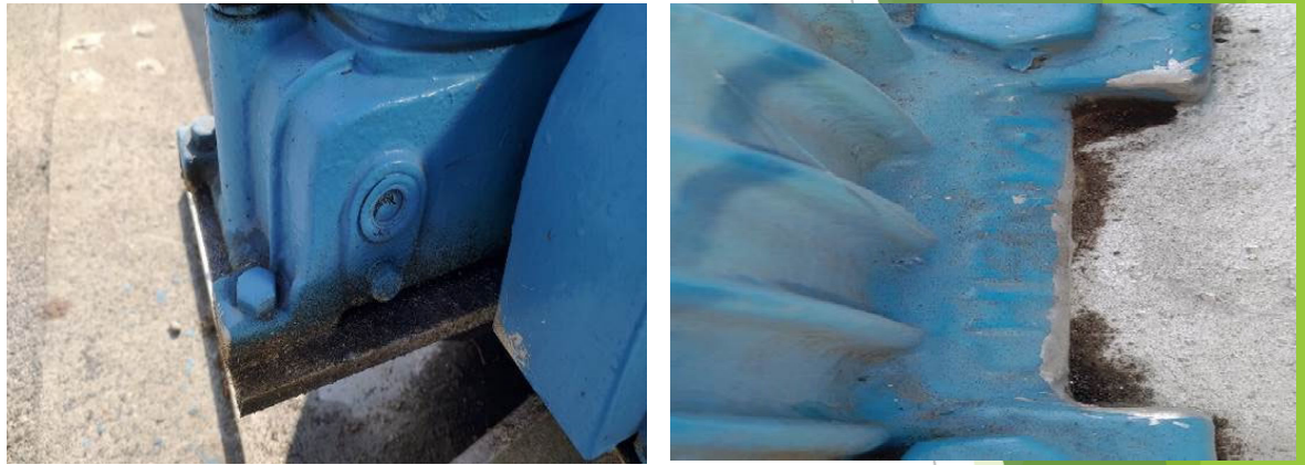
進水口吊門機開度計減速機漏油狀況
