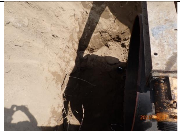
A2 標曾文一號水管橋 A2 橋台至 W18 工作井明挖段地層出露
