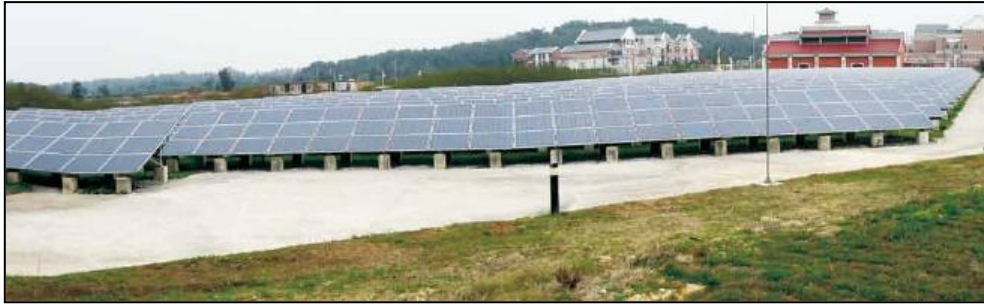
圖 3-59 金門金沙文化園區太陽光電站
