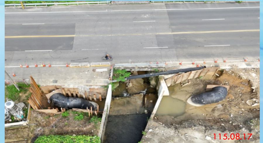
芴子園橋河底管鋼管
