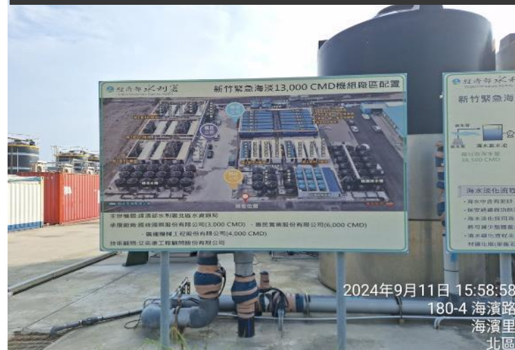
工區南側臨時海淡處理設施
