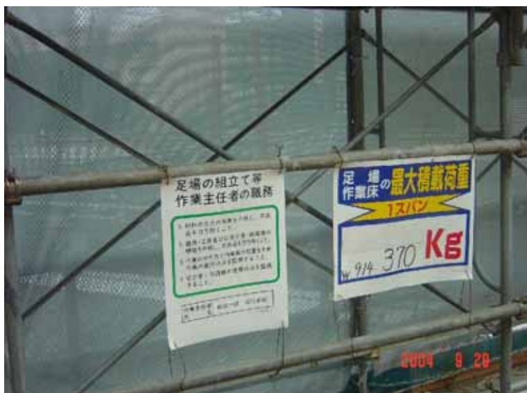
照片 7. 施工架上之載重限制應於明顯易見之處明確標示。
