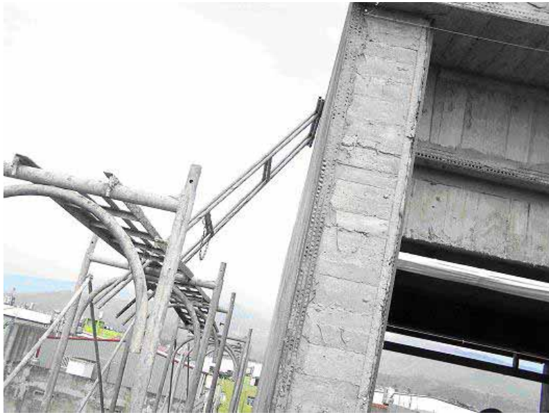
照片 8-1. 施工架上之違規設置 梯子當上下設備。
