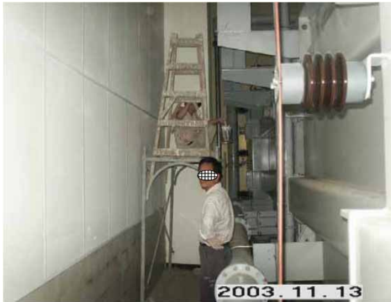
照片 8-2. 施工架上之違規設置 合梯從事油漆作業。
