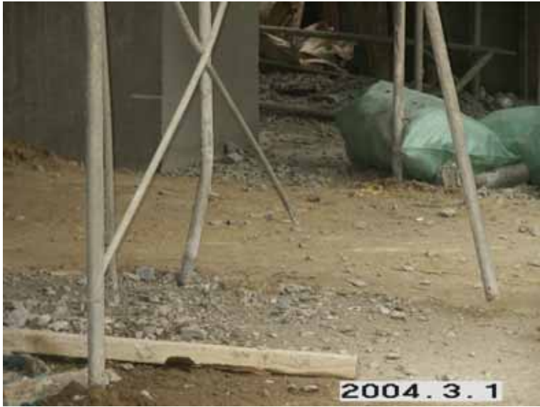
照片 6-1. 施工架之立架腳柱變形，影響施工架之強度。
