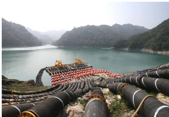
石門水庫壩頂緊急抽水系統
