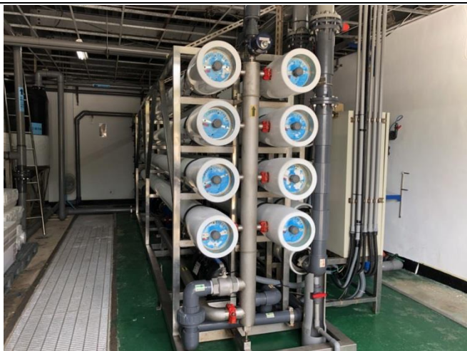
RO 逆滲透機組
