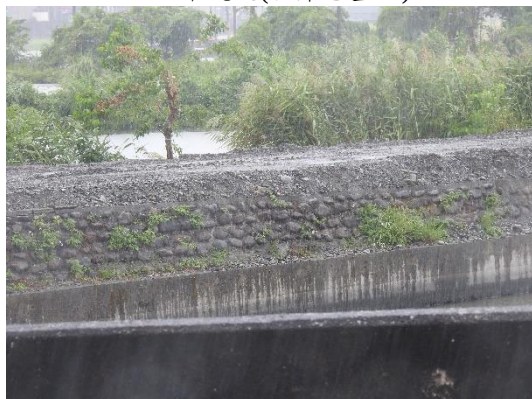
前期工程護岸採用漿砌石坡面；底部存在垂直落差
