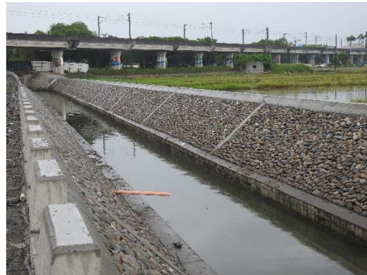
護岸採用漿砌石坡面；基座存在垂直落差
