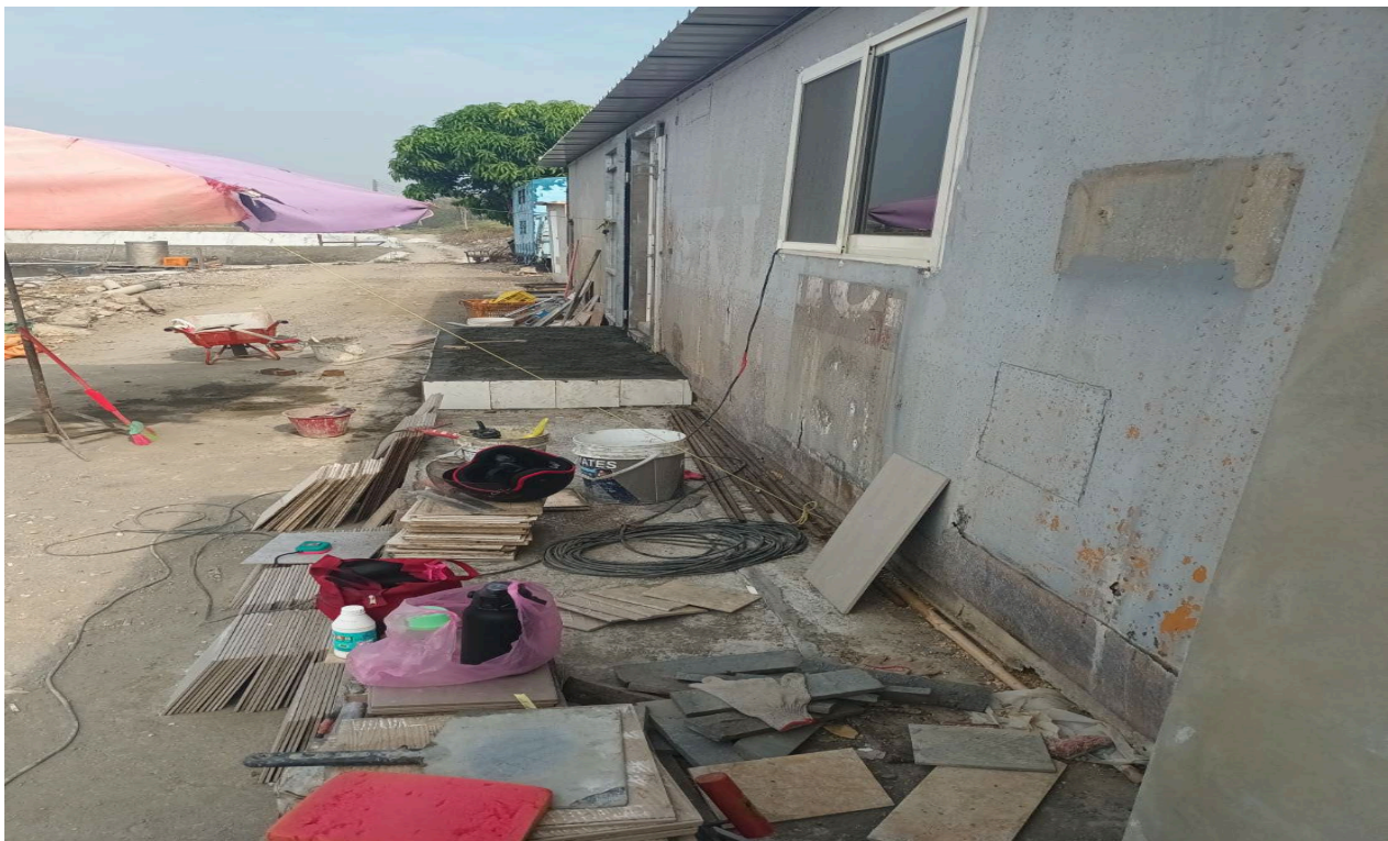
112.01.05 日行為人李○憲於高屏溪屏東縣新園鄉五族段未經許可放置貨櫃及土石施作處照片
