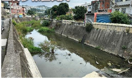
尖山下圳排水水泥工程造成生物多樣性喪失
