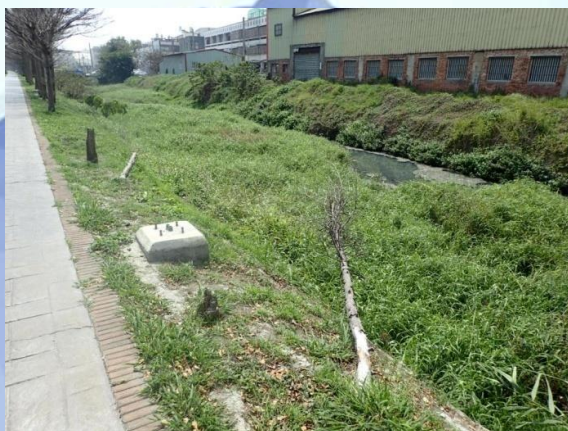
部分河道旁有景觀樹木乾枯未整理
