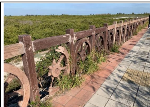
既有牛輪護欄損壞
