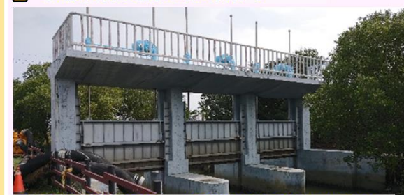
閘門結構老舊，鋼筋鏽蝕滲出牆面
