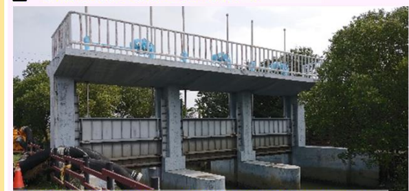
閘門結構老舊，鋼筋鏽蝕滲出牆面
