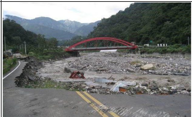
民國 98 年莫拉克颱風中 47 路基嚴重崩塌
