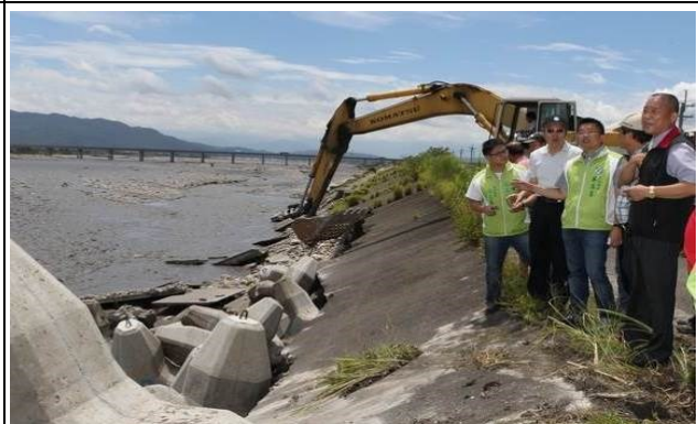
民國 102 年蘇力颱風期間廊子堤防基腳淘刷
