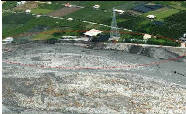
民國 93 年艾利颱風白布帆堤防破堤
