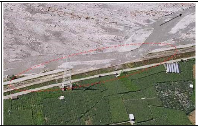
民國 93 年敏督利颱風內灣堤防破堤
