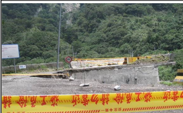
民國 98 年莫拉克颱風白布帆大橋路基崩塌
