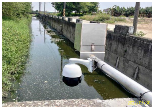
超音波水位計觀測水位
