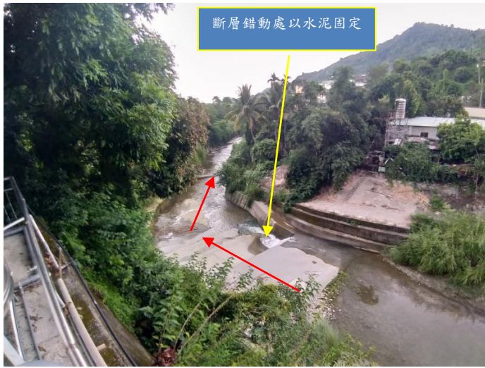
➤ 圖 7. 斷面一：由上往下望，問題不僅同上，且整河道幾皆全面水泥化，111-8-19。
