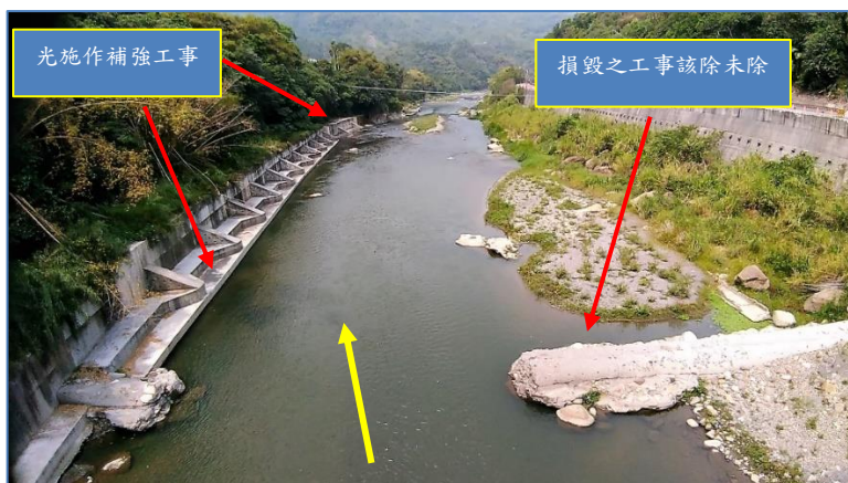
➤ 圖 21. 107 年間左岸雖補作系列工事，但卻未把右岸之損毀工事一併去除，致不僅該岸之淤積更為加重，且洪流照樣沖擊左岸，109-3-20。
