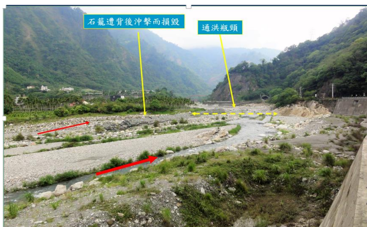
➤ 圖 3. 該河段出現通洪瓶頸，致左岸之石籠遭背後沖擊而損毀，有必要加以拓寬，100-5-18。
