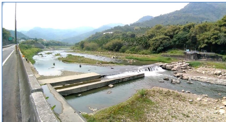
➤ 圖 22. 福龜圳二取水堰出現之上淤下淘，不免多少影響該河段，同需疏浚，109-3-20。
