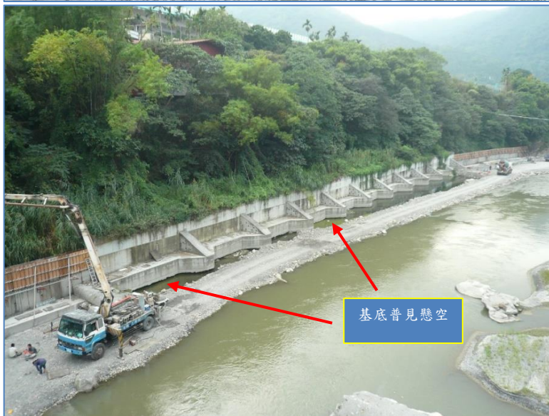
➤ 圖 16. 從既有保護工之基底普見懸空，且還有岩石支撐看來。若當初能多疏浚對岸、並調整流路，該些工事應可省下，107-11-9。
