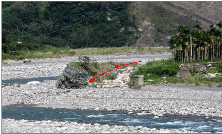
➤ 圖 4. 左側石籠護岸遭背後沖擊而致損毀之近照，若不拓寬該段之河道，問題難解，100-5-18。
