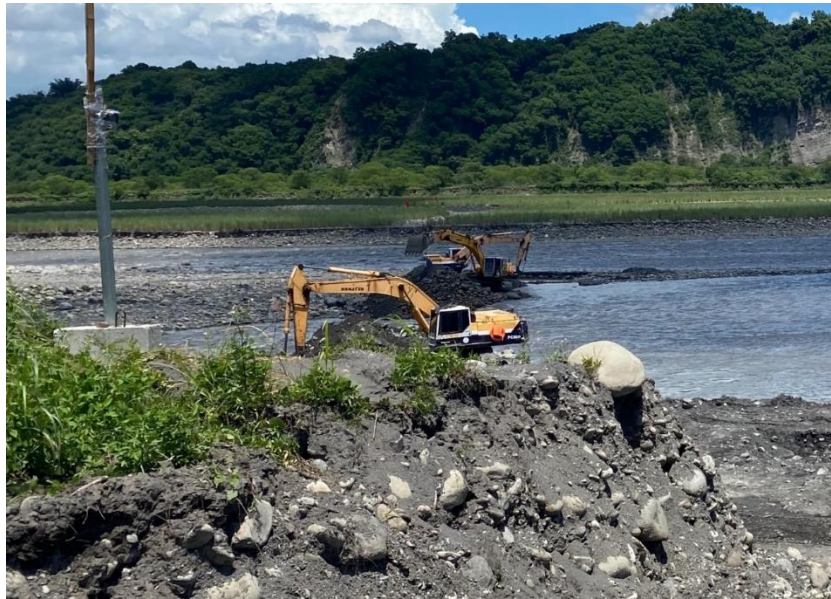
圖 9-8 高屏地區河槽補注設施毀損維護情況
