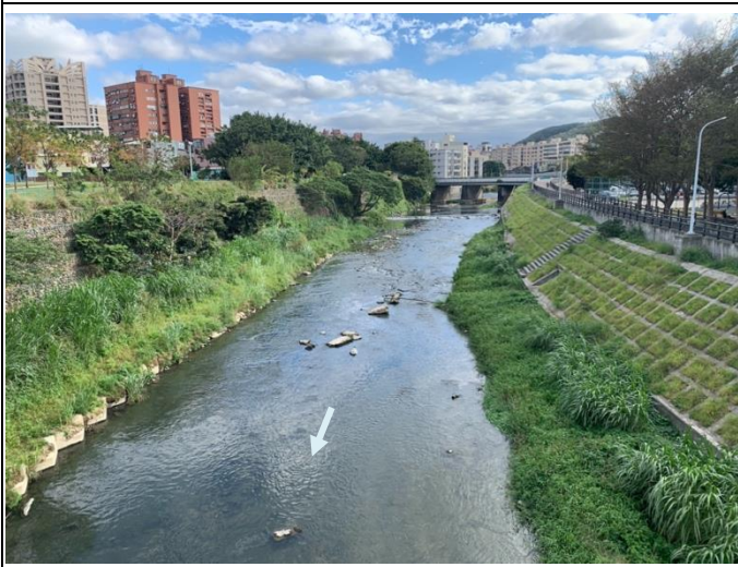
說明：中華路至中山路間右岸為箱籠結構，左岸為混凝土格框護岸。右岸護岸植被覆蓋狀況佳，左岸則為凸岸於低水護岸外淤積處有植被建立 日期：2022.01.19
