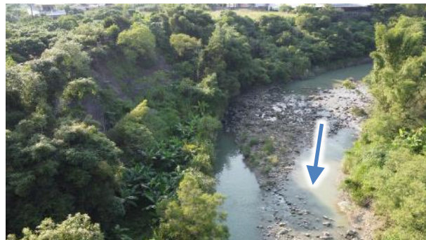
河道及右岸邊坡崩塌環境 (110.10.05)
