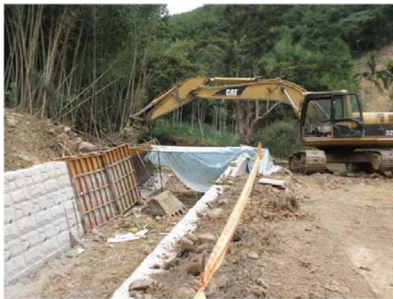
挖土機挖斗脫落狀況
