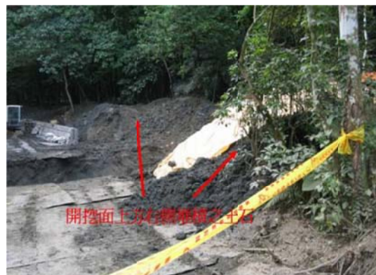
現場開挖面上方右側堆積之土石
