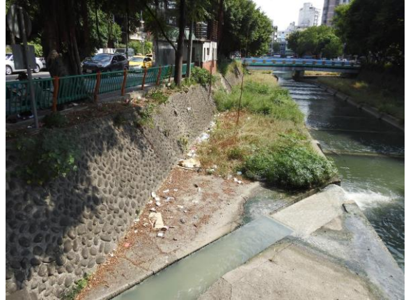
圖 16、現有污水放流管線之一
