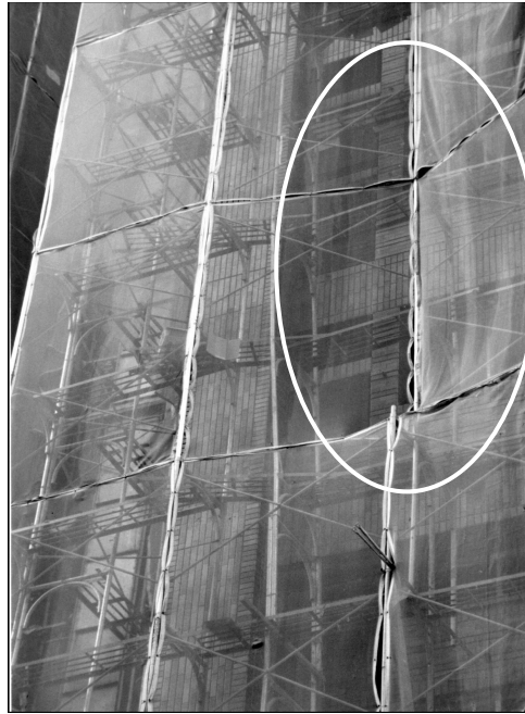
圖 18 工地現場建築物外型特殊造成施工架扭曲之情形
