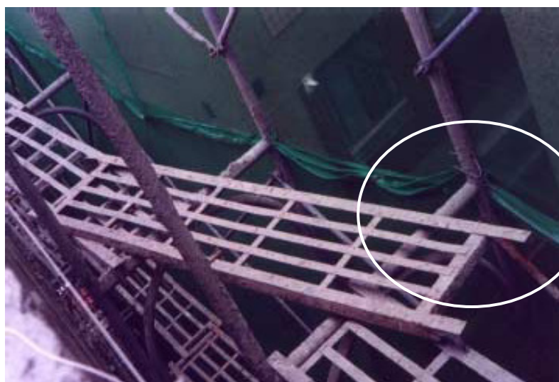
圖 16 附工作板橫架未鉤於施工架上且無固定之情形
