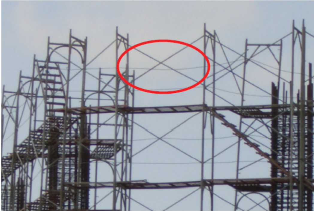
圖 20 安全母索未使用中間支撐
