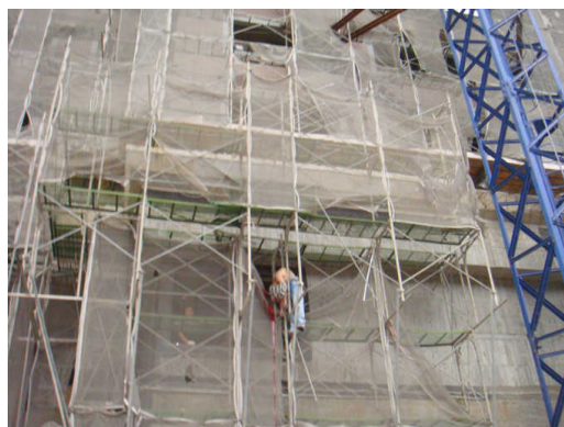
圖 5 勞工墜落位置圖(來源：北區勞動檢查所)
