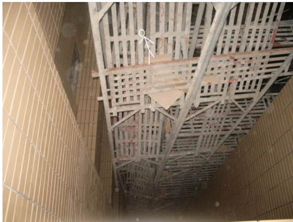
圖 9 施工現場之施工架倒崩塌情形(來源：北區勞動檢查所)
