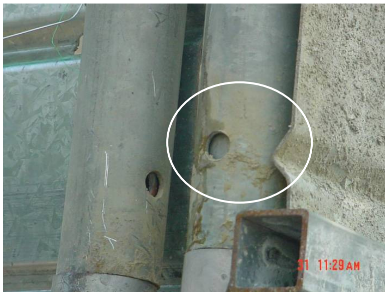
圖 11 施工架無插銷固定之情形
