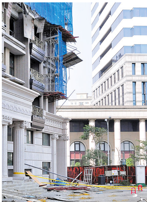
圖 3 因施工架踏板脫落造成勞工死亡 (來源:中時電子報)
