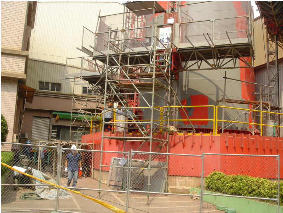
圖 6 事故發生之煙囪現場
