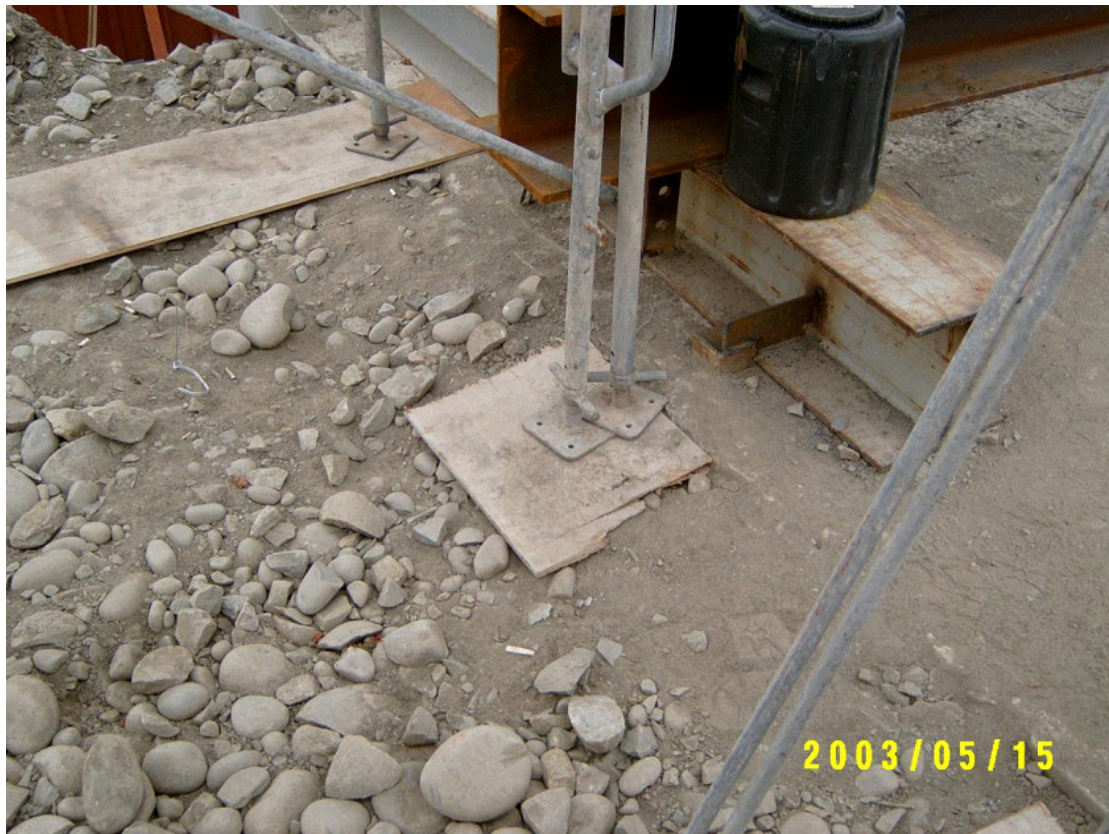
圖 14 施工現場架設不平整
