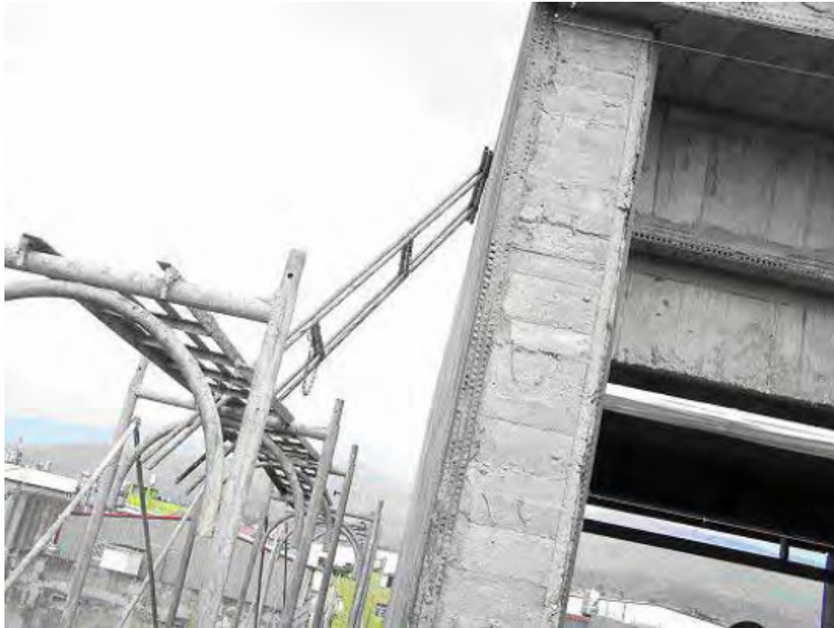
圖 12 施工架之上下設備未正確設置(來源：勞動檢查處)
