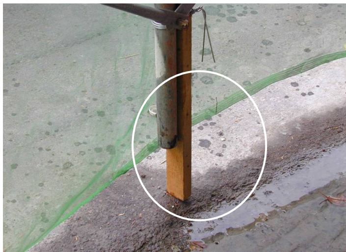
圖 13 施工架底部以木頭搭接之情形
