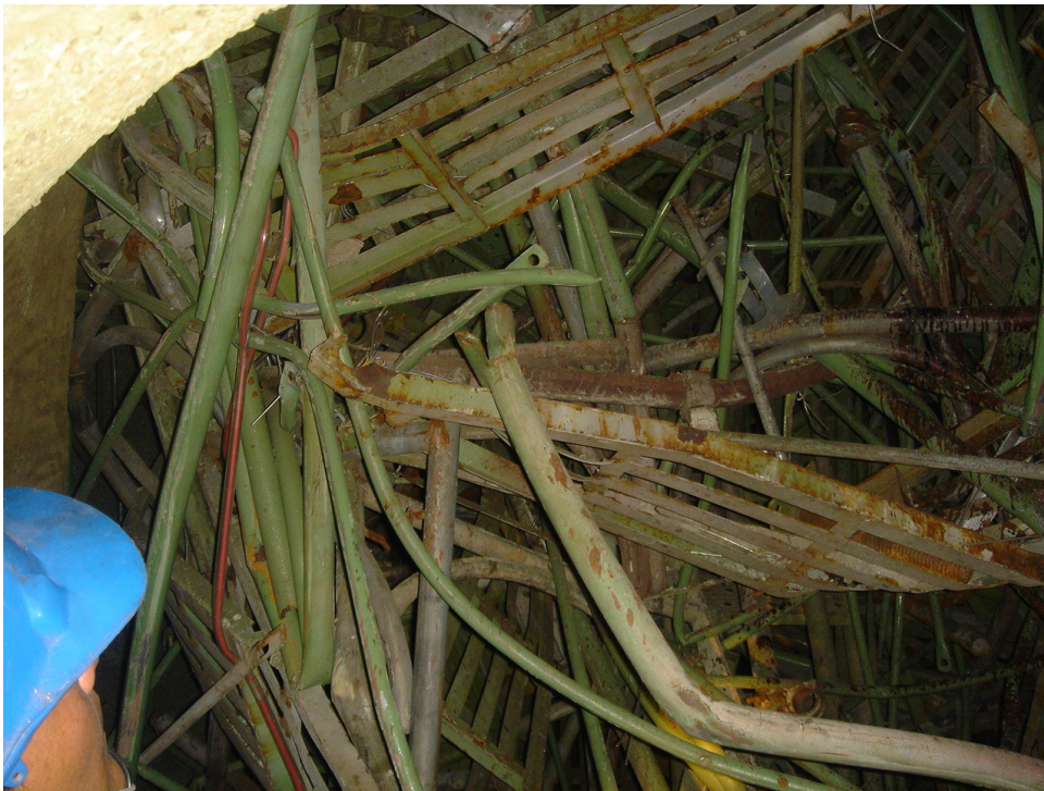
圖 7 煙囪內部施工架崩塌之情形
