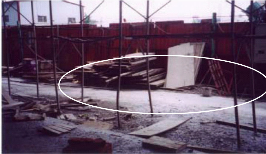
圖 10 框式施工架因拆除交叉拉桿而造成變形
