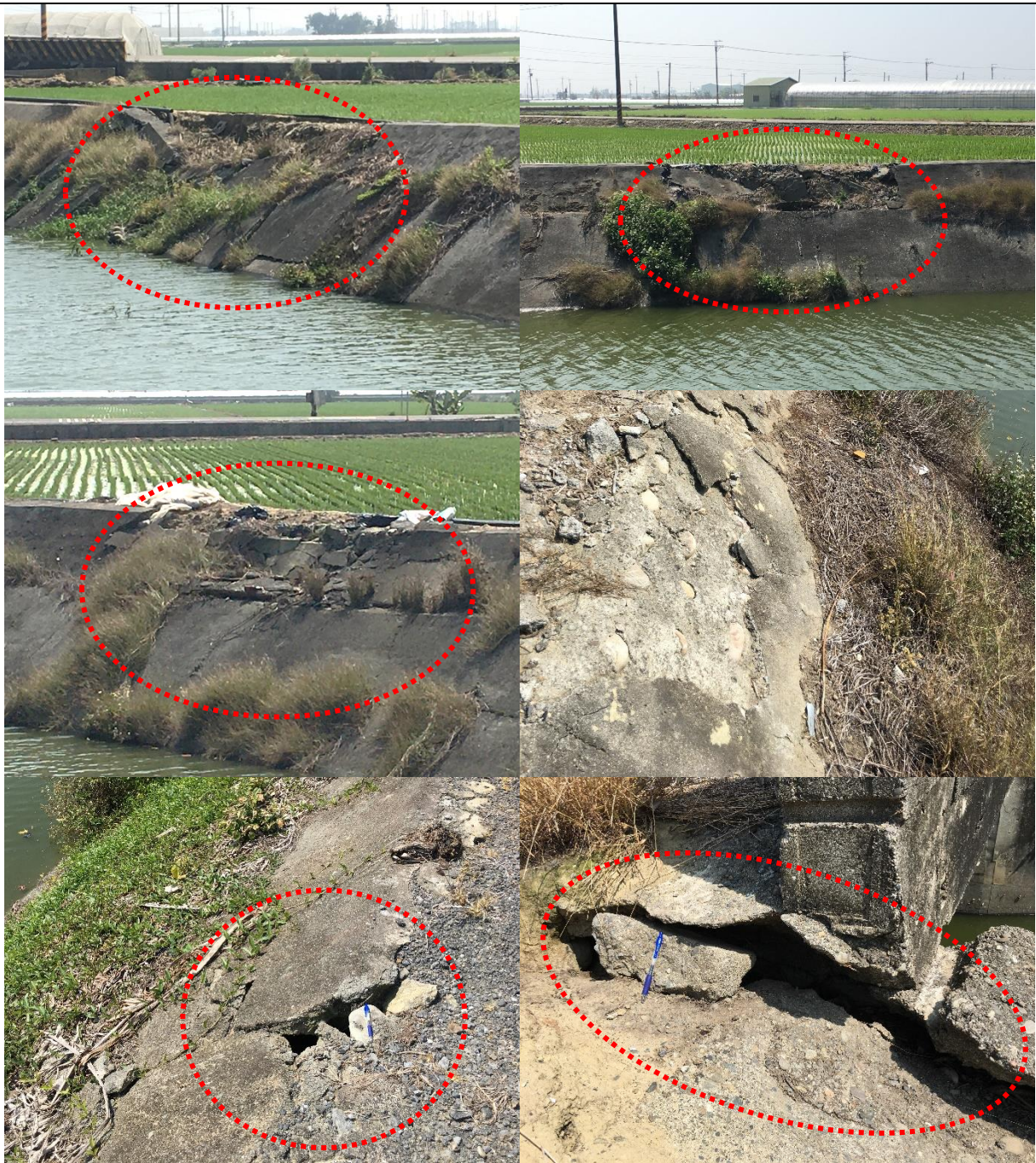
圖 3-1.5 鴨母寮排水數處破損未修繕渠段 (勘查日期：111/03/02)
