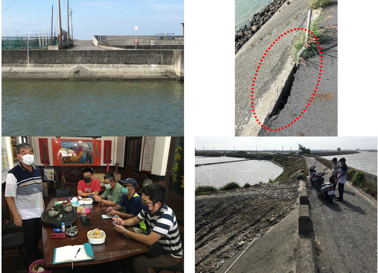
圖 3-1.3 討論網寮海堤及排水破損處修繕事項 (勘查日期：111/05/19)
