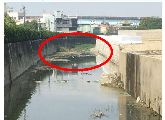
埤麻腳排水渠道雜草及土石淤積
