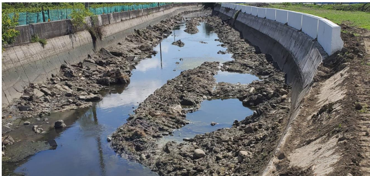
圖 6-1.12 埤麻腳排水部分護欄未施作(照片時間：2021 年 6 月 18 日)
