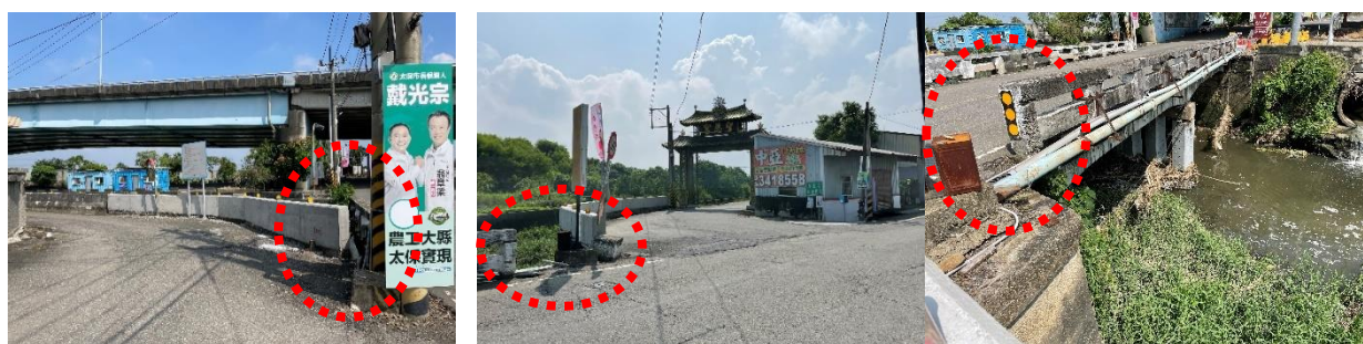
圖 5-2.4 埤鄉橋與埤麻腳排水缺口示意圖 (照片時間：111/09/08)
