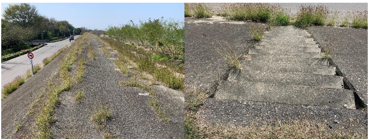
圖 3-4.2 堤頂雜草缺乏維護、階梯寬度不足且未設扶手 (勘查日期：111/1/26)
