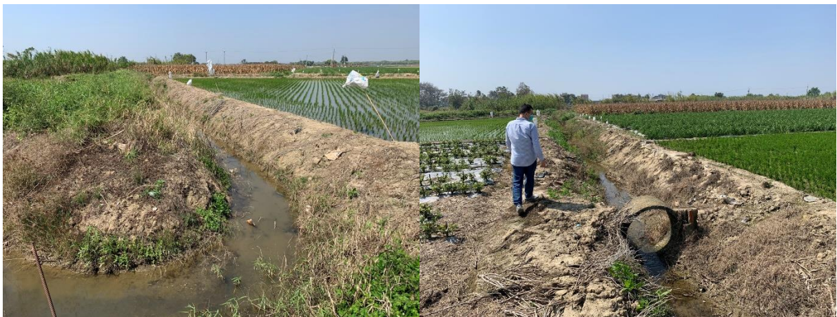
圖 3-1.4 豐稠村農水路灌排未施作渠段 (勘查日期：111/03/02)
