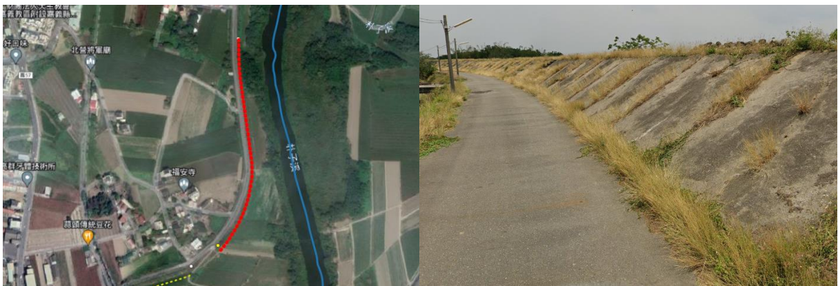
圖 3-3.6 蒜頭堤防-右岸編號 50 勘查點 (長度約 430 公尺)
