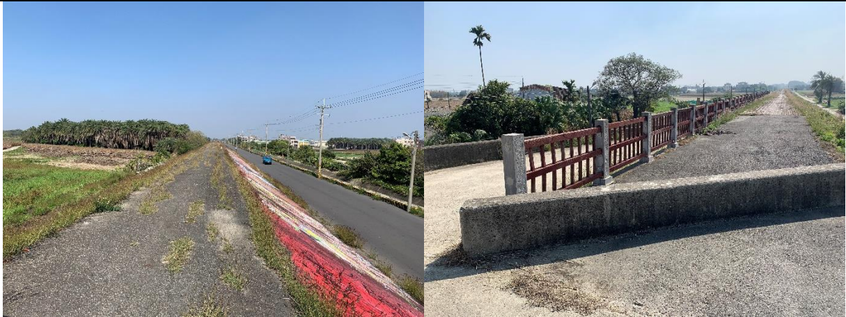
圖 3-4.3 堤內面遭民眾塗鴉、僅部分堤段裝設扶手 (勘查日期：111/1/26)
