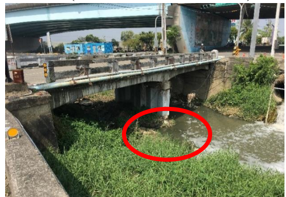
埤鄉橋地梁露出未改善
