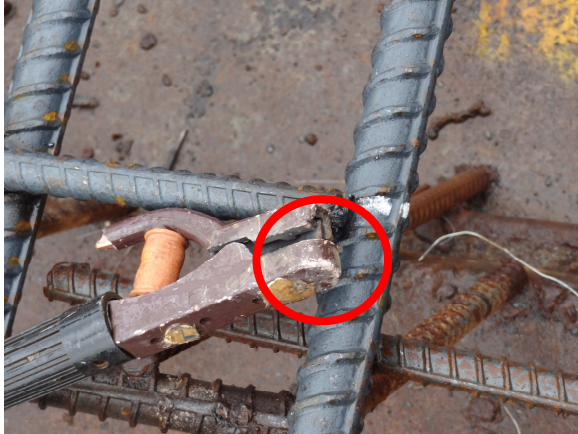
現場使用之焊接柄破損情形
