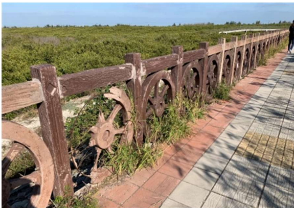
既有牛輪護欄損壞
