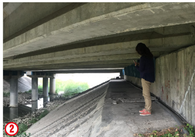
國道陸橋阻斷堤頂道路動線，現況橋下高度約1.5米，不利行人及自行車通行。
