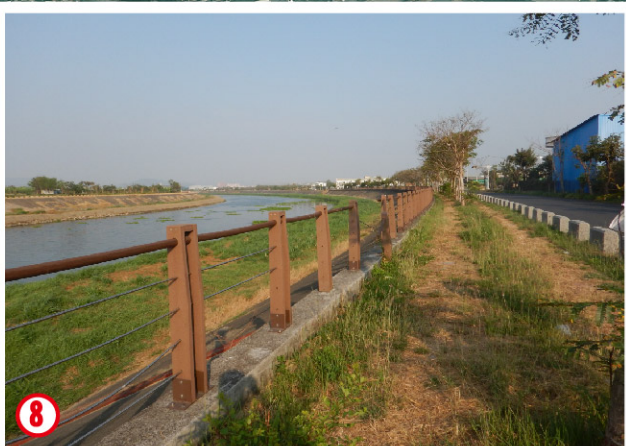
前州橋-維仁橋部分河堤設有護欄，惟部分設施老舊破損，雜草覆蓋步道。
