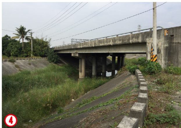
國道陸橋阻斷堤頂道路動線，現況橋下高度約1.7米，不利行人及自行車通行。
