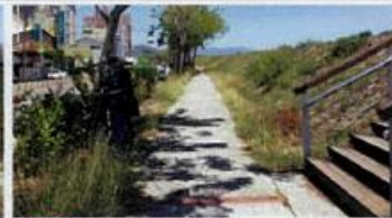
8 步道/單車道寬度不足
