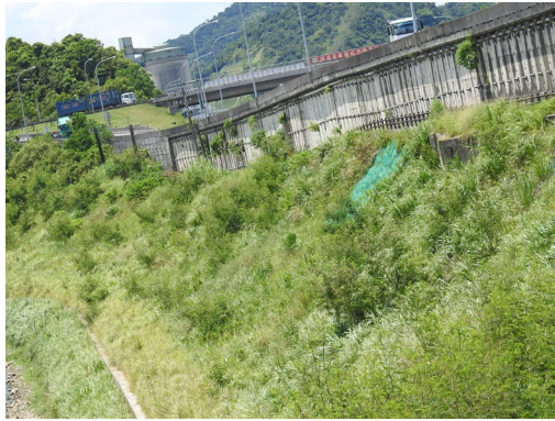
109/08/14 工程範圍滑落邊坡
