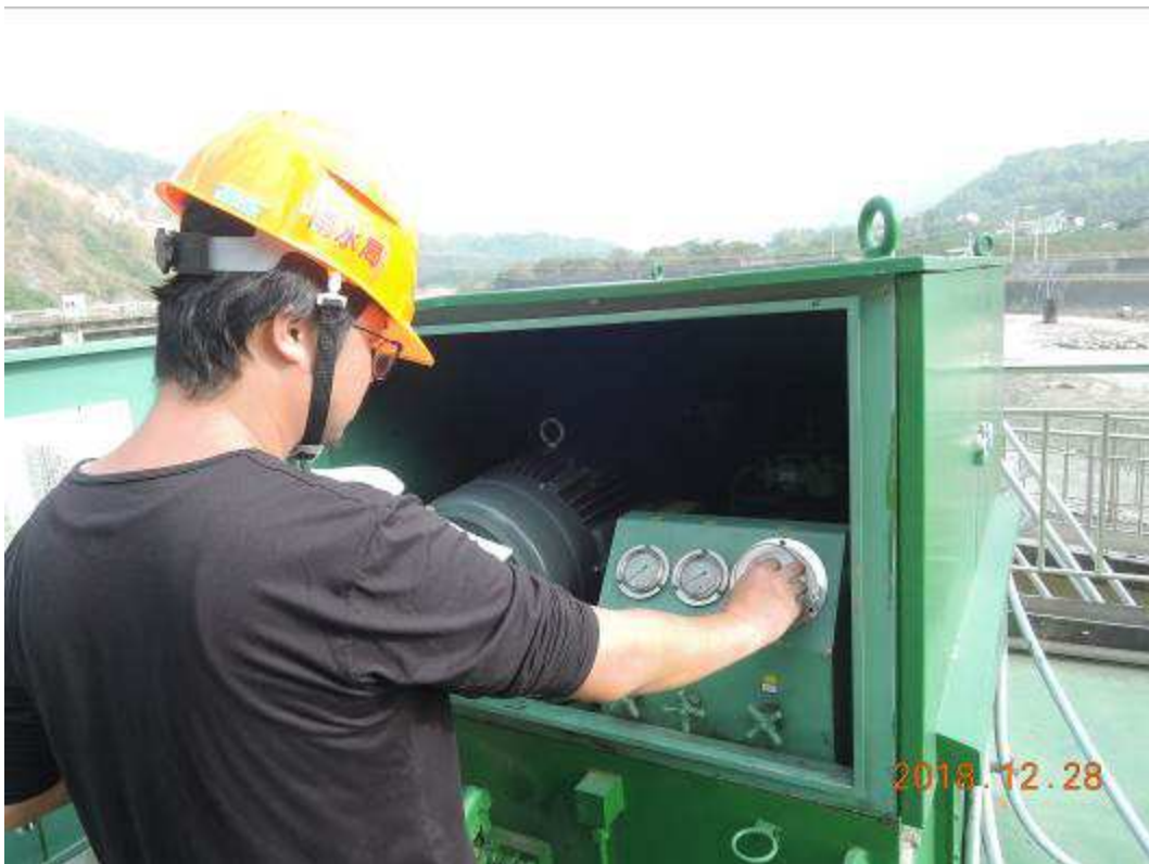
圖 4.4.2：沉砂池排砂閘門-油壓設備運轉檢查
