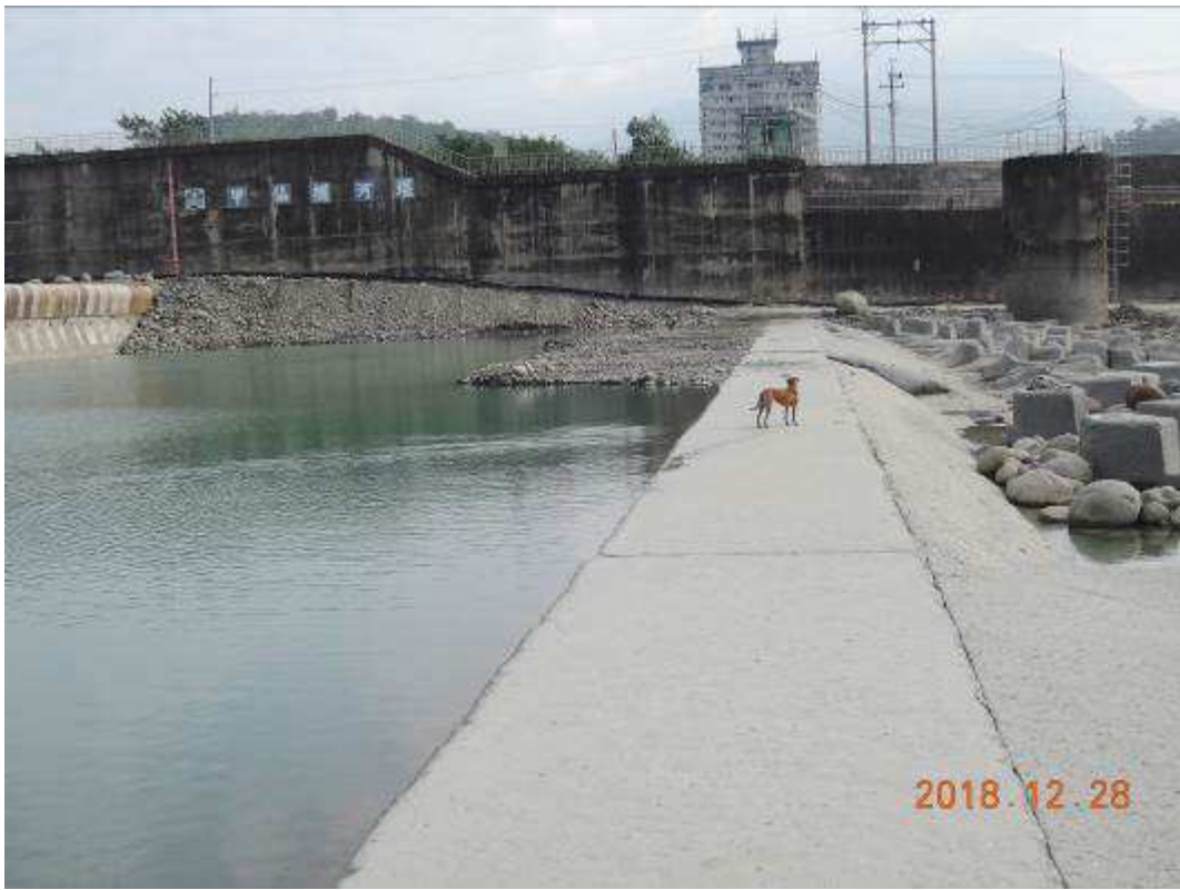
圖 3.1 尾檻磨損-107 年開口二期完成修復改善
