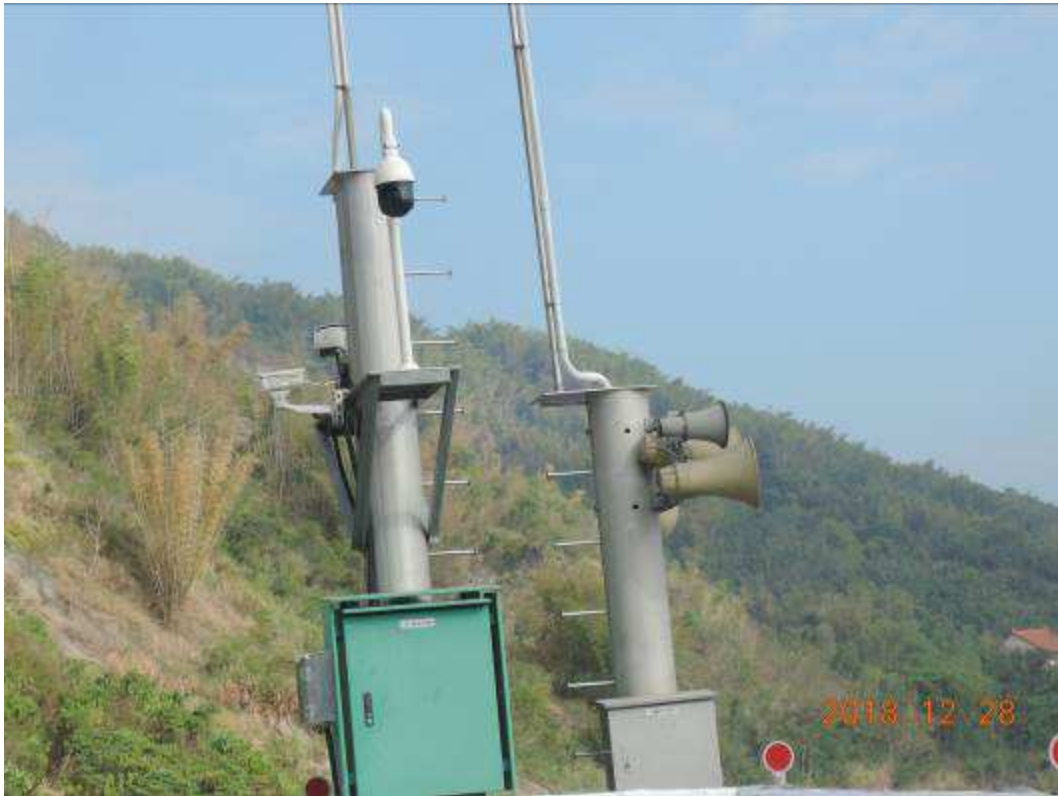
圖 5.1.1：放水警報廣播系統-上游站設備檢查
