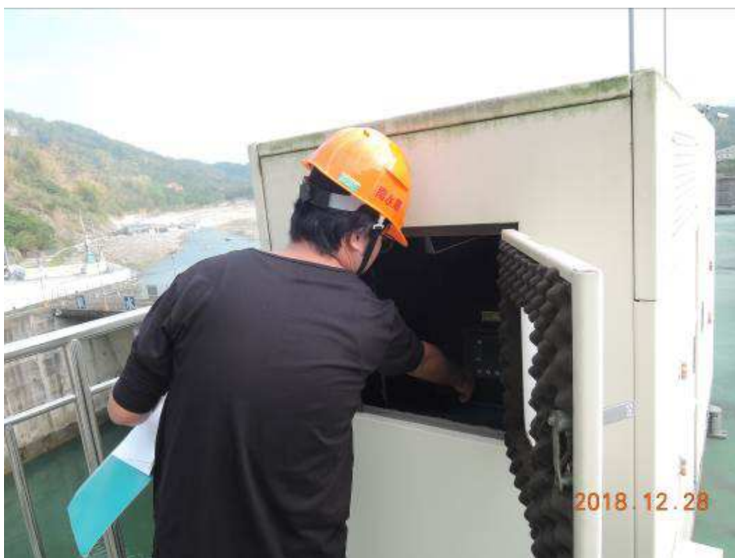
圖 5.4.2：備援緊急發電機(60KW)檢查
