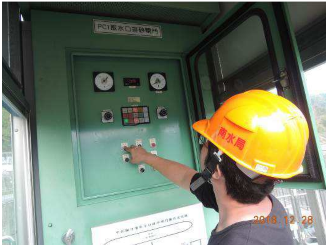
圖 4.3.1：取水口排砂閘門-控制箱電源及運轉檢查
