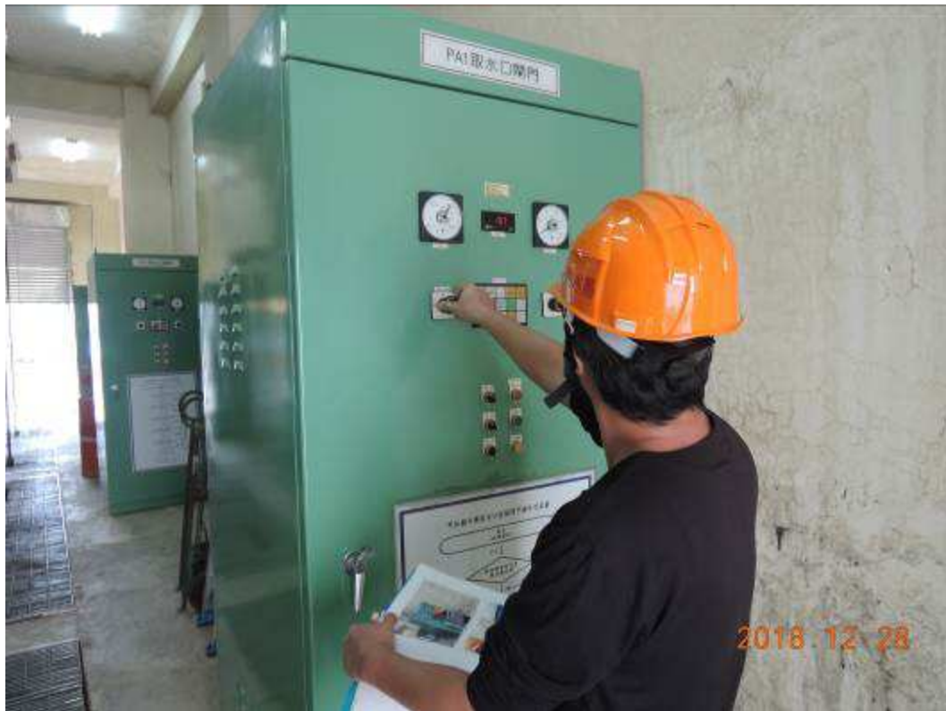
圖 4.2.1：取水口控制閘門-控制箱電源及運轉檢查
