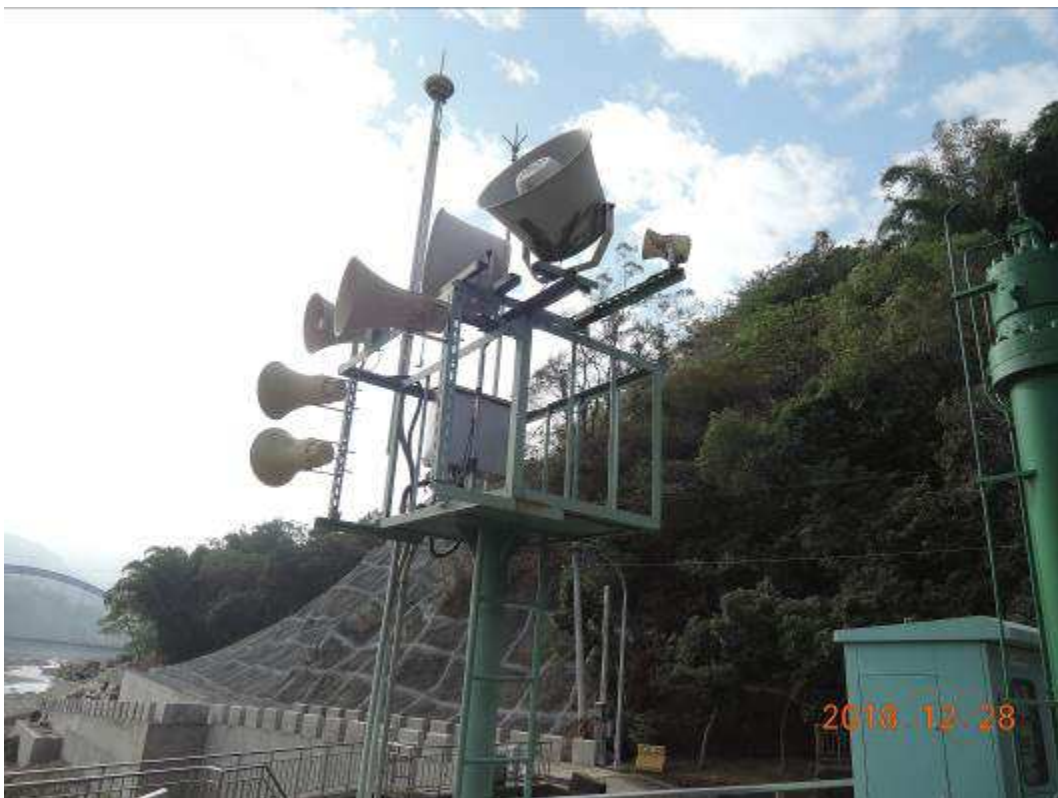
圖 5.1.2：放水警報廣播系統-攔河堰站設備檢查
