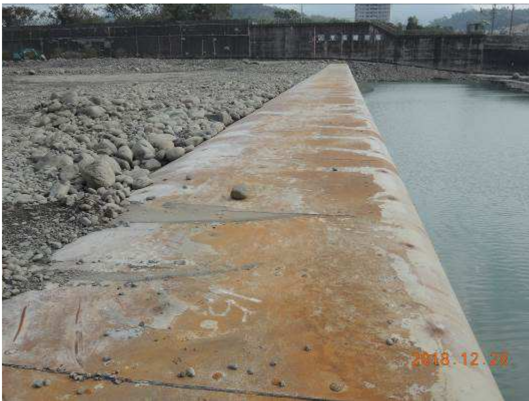
圖 1.1.2 鋼板橡膠墊破損情形-107 年溢流堰修復工程完成改善
