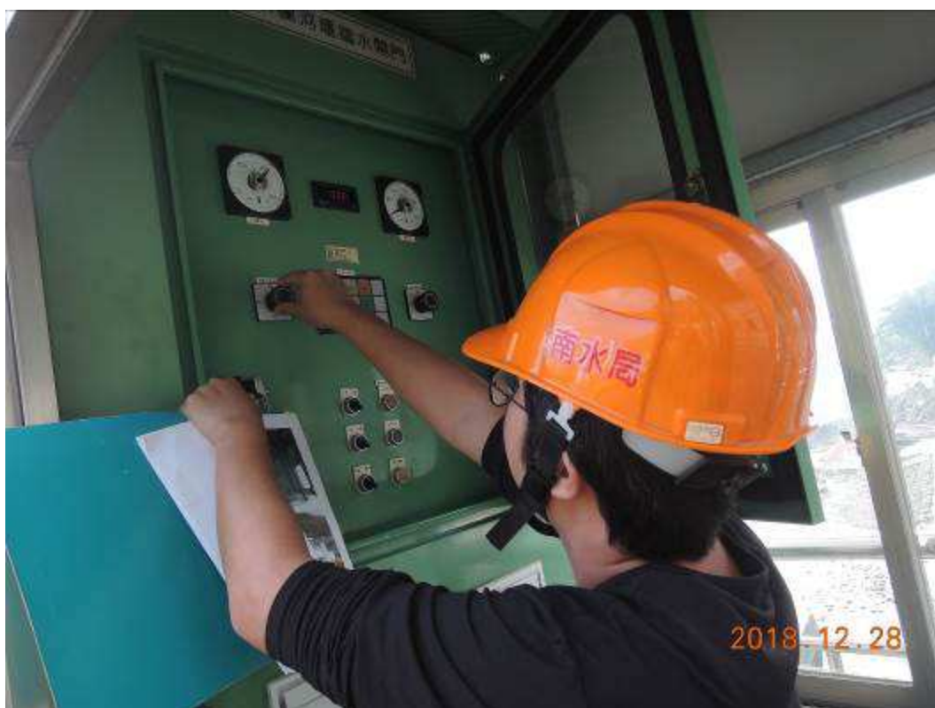
圖 4.1.1：排砂道擋水閘門-控制箱電源檢查
