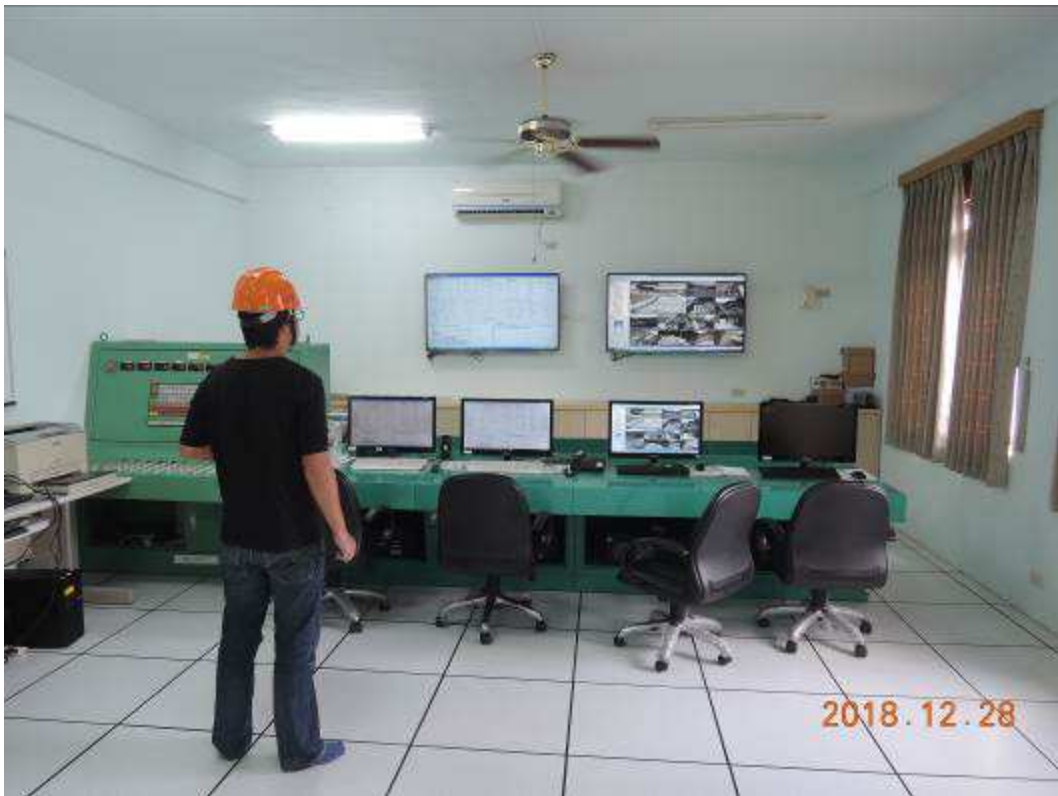
圖 6.4：監測儀器檢查-控制室監控主機
