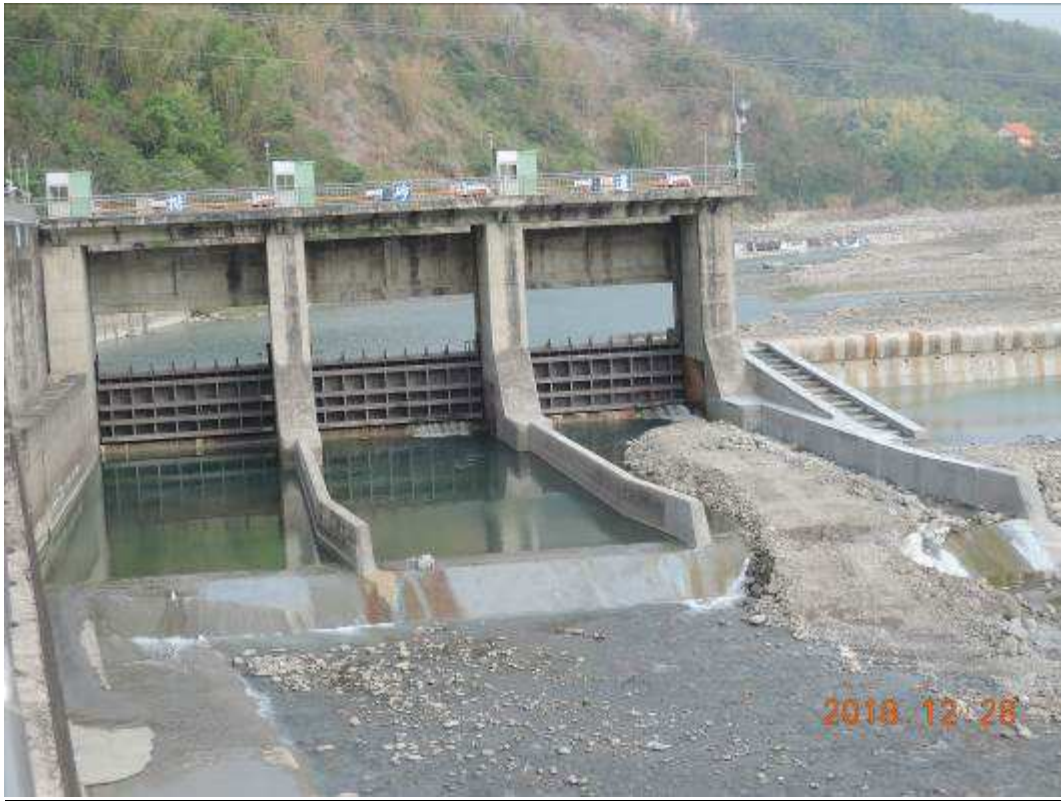
圖 1.2.1 #2 及#3 排砂閘門與堰面鋼板交接處有局部滲水之情形
