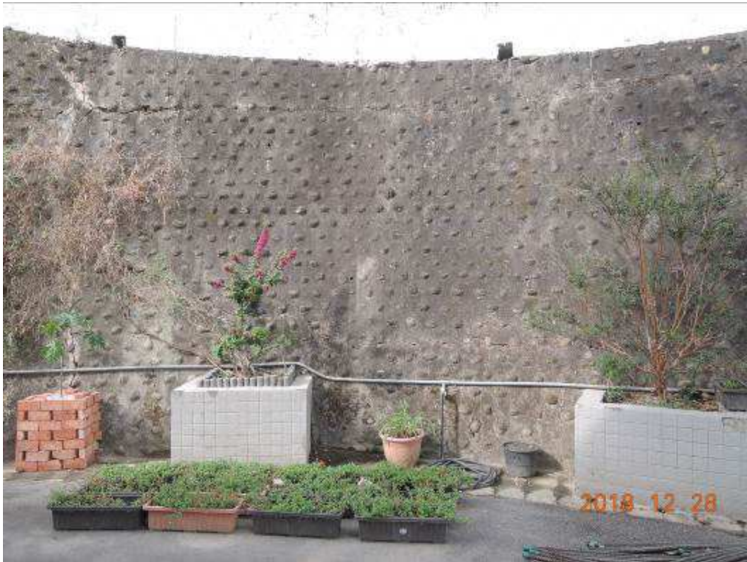
圖 7.1： 堰區辦公室道 A 下邊坡多處裂縫，目前持續注意
