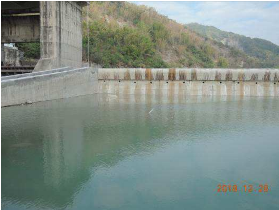
圖 1.1.1 堰體下方有局部鋼筋裸露情形-107 年溢流堰修復工程已完成改善
