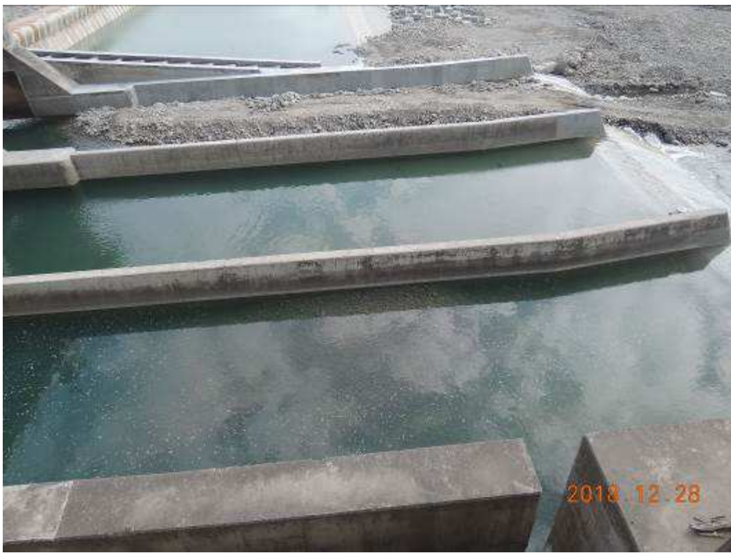
圖 1.2.2 #3 導流牆磨損較嚴重-107 年開口二期完成修復改善
