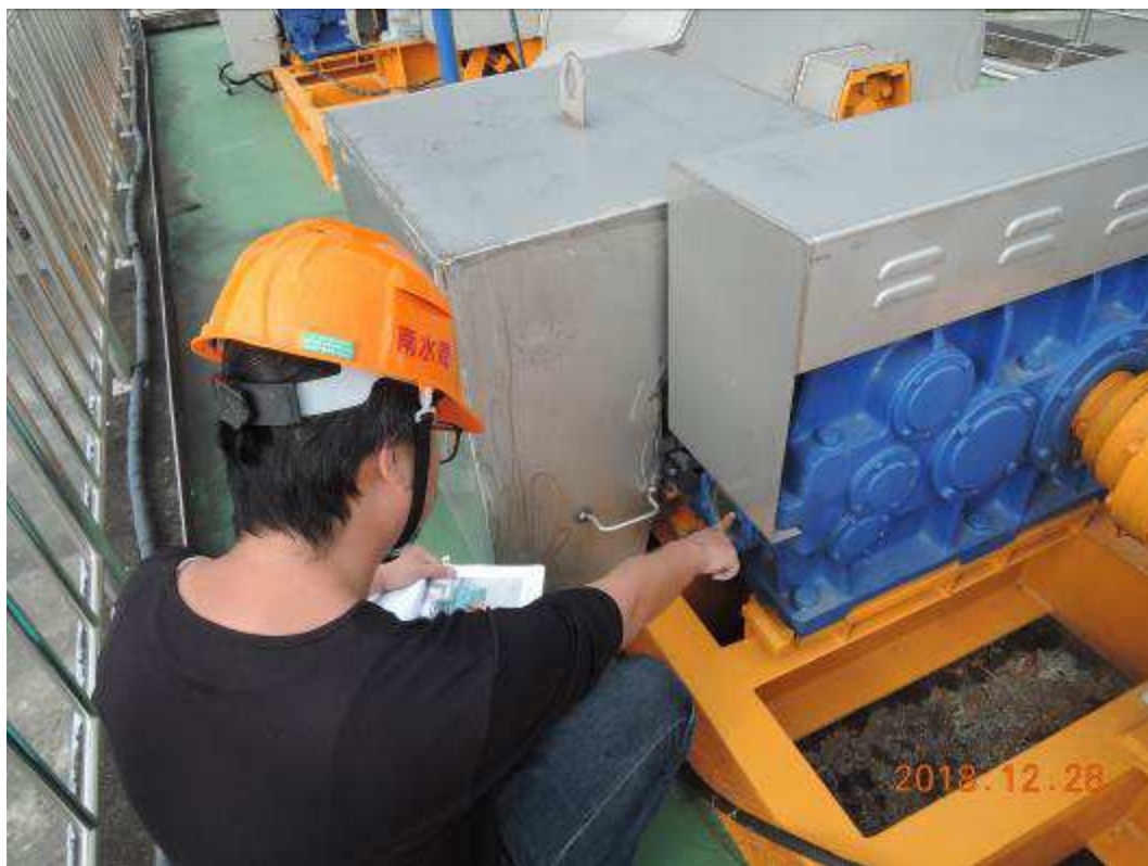
圖 4.2.2：取水口控制閘門-外觀及齒輪箱油位檢查
