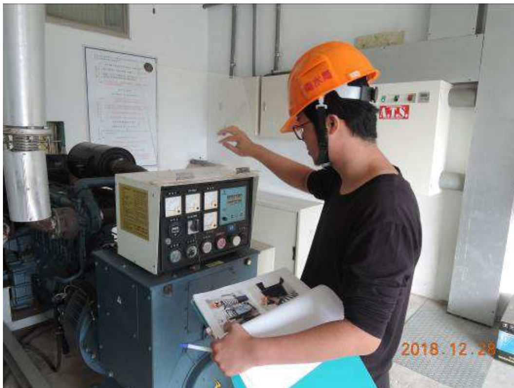
圖 5.4.1：控制室緊急發電機(125KW)檢查
