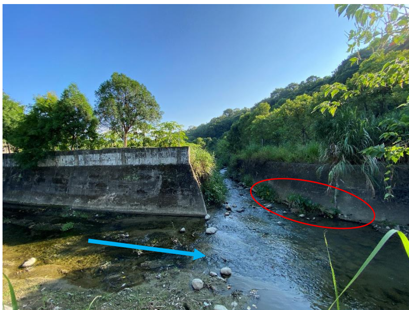
圖 4.4.3-3 D 案工區外護岸基腳有掏刷情形(紅圈處)
