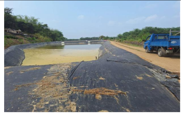
113.4.8 日行為人曾國勤於高雄市美濃區廣林段地號1232 未經許可挖掘水池欲種植水蓮處照片
