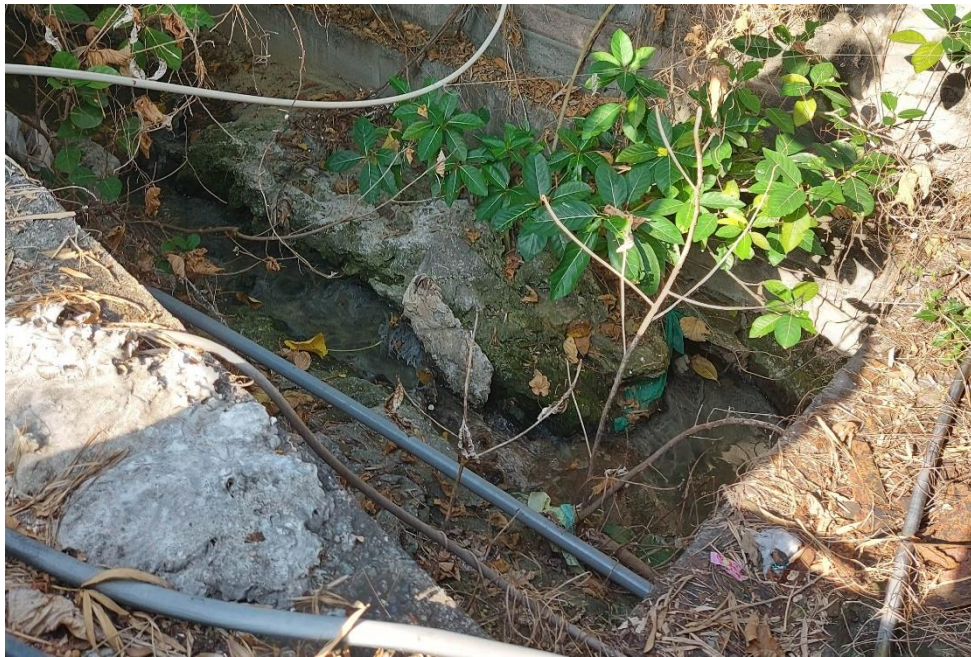
圖 4 水興宮排水現況
