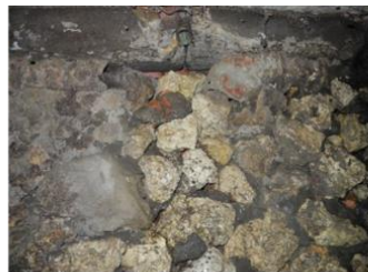
圖 E：水泥重新修補過之硃砧石
