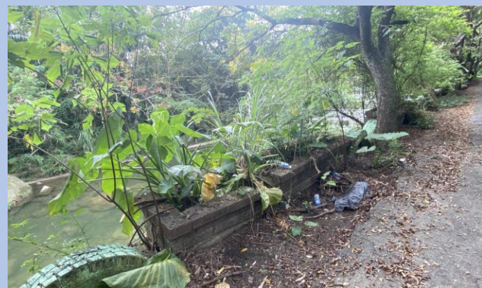
部分花台崩塌毀損
