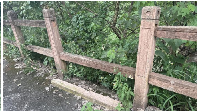
部分欄杆毀損
