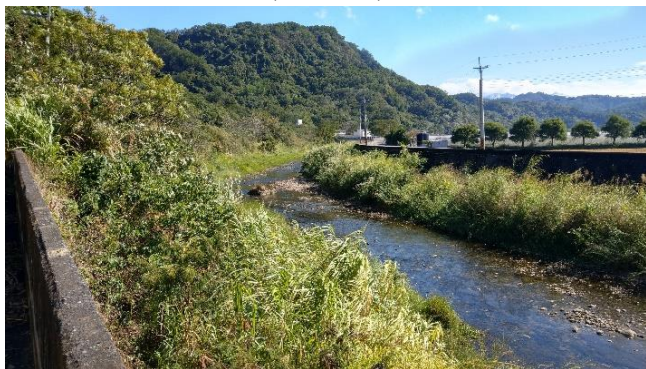
(坡腳受侵蝕段)
