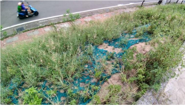
圖 1. 以抗沖蝕植生網覆蓋，日後不免出現損毀、甚塌陷，大里溪右岸堤防，樹王埤大排匯入段。
