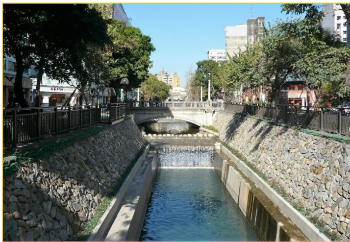
圖 8. 綠川分洪箱涵出口下游段，因兩側護岸被加一層砌石，基腳亦墩厚，致通洪斷面縮減，潛伏水患危機，107-2-15。
