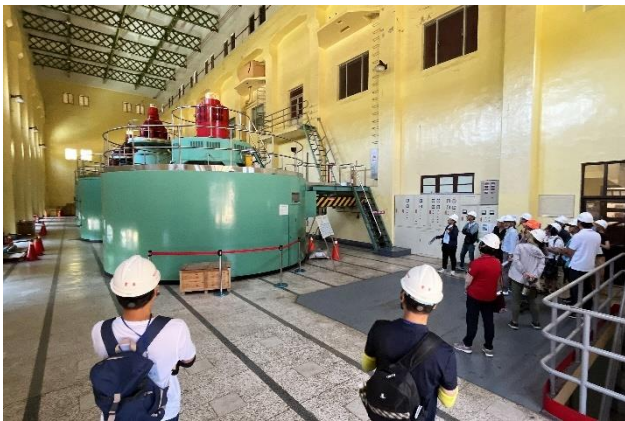
廠內發電機組設備
