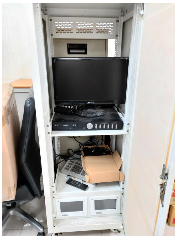
36 監視器主機及機櫃
