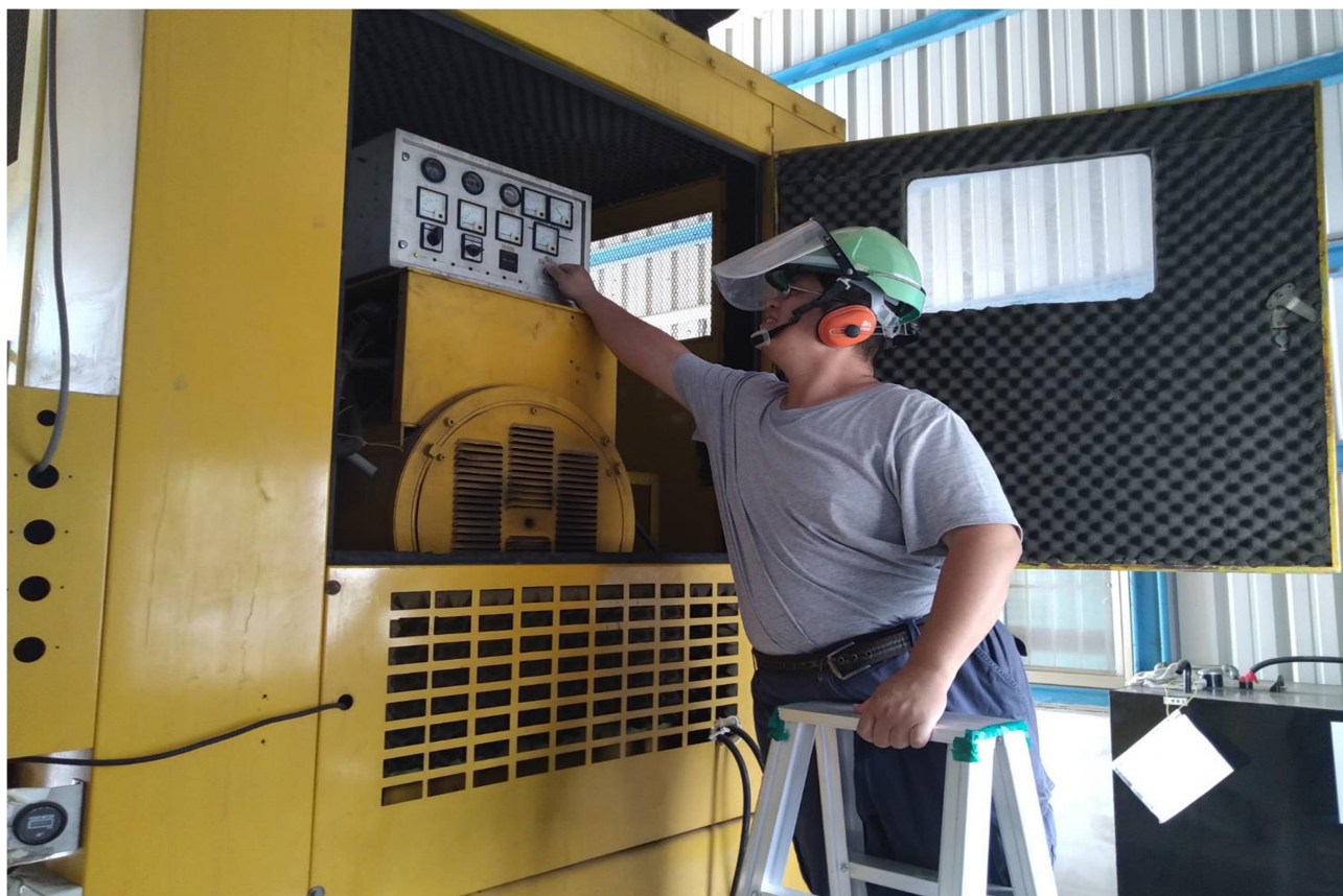
蘭潭場發電機試運轉
