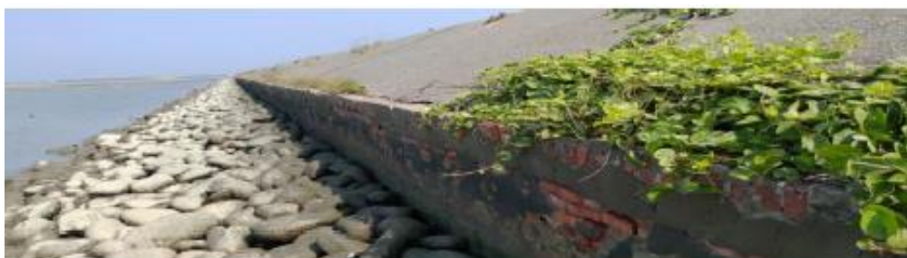
既有磚造基礎斑剝
